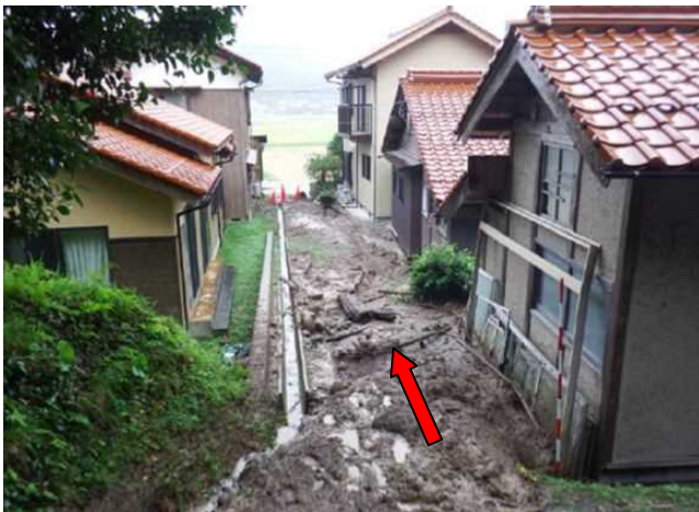
鳥取市鹿野町岡井地区被災状況(9/12 被災)
