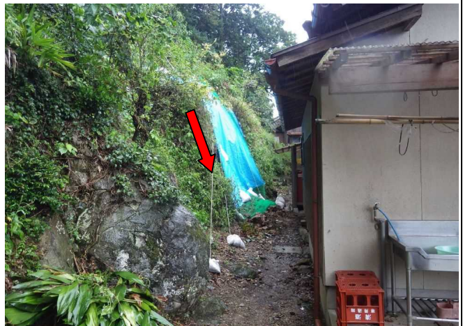
米子市淀江町福井地区被災状況(9/12、9/20 被災)
