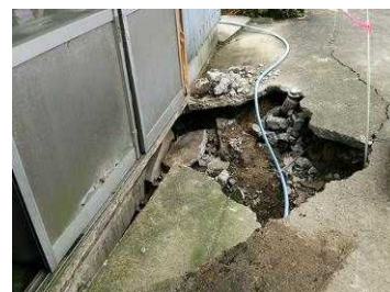
破損した牛舎地盤(倉吉市)
