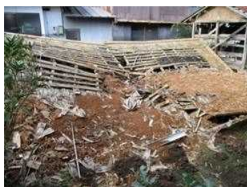
倒壊した出荷調整施設(北栄町)
