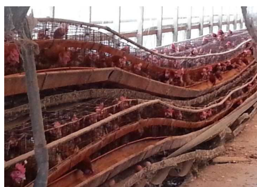
大きく歪んだ養鶏ケージ(倉吉市)
