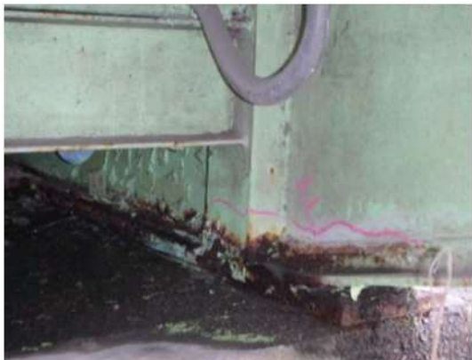
【上部工（主桁）：腐食、健全性Ⅲ】
