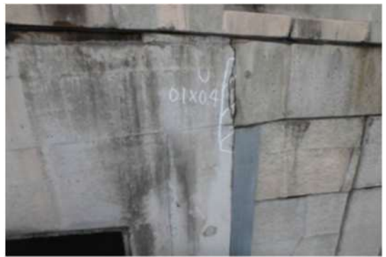
【翼壁部（ウイング）：うき、健全性Ⅲ】
