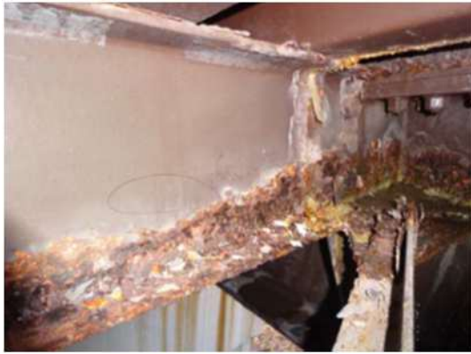
【横梁：腐食、健全性Ⅲ】
