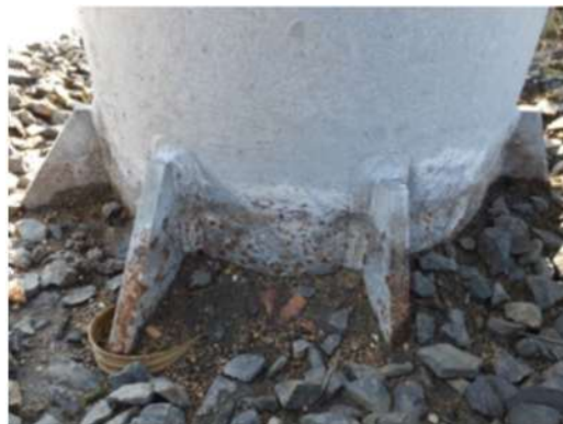
【支柱基礎：腐食、健全性Ⅲ】
