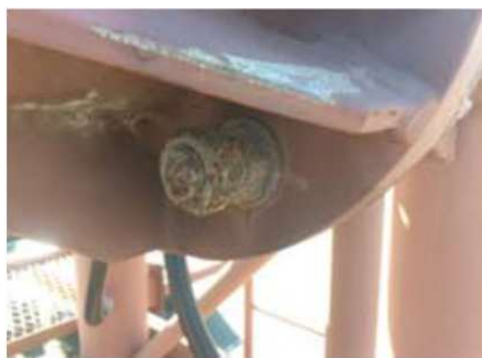
【横梁取付部：腐食、健全性Ⅱ】
