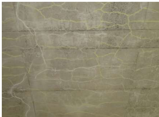
【本体工（頂版）：ひびわれ、健全性Ⅱ】
