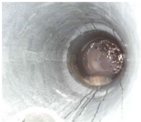
【支柱内部：滞水、健全性Ⅱ】
