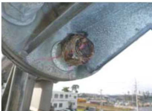
【横梁（標識板取付部）：腐食、健全性Ⅲ】
