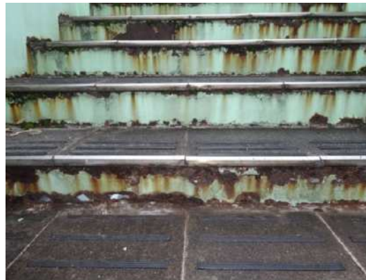
【階段部（蹴上）：腐食、健全性Ⅱ】
