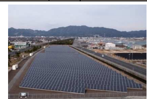
竹内西緑地発電所
