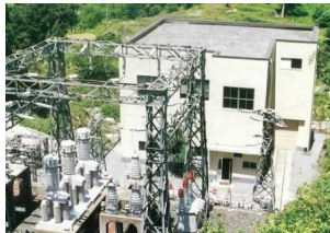
小鹿第一発電所
