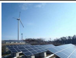
鳥取放牧場発電所
