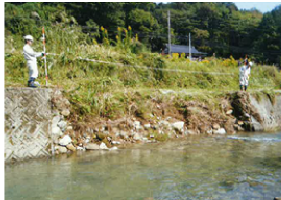
砂見川 (鳥取市下砂見) 護岸崩壊
