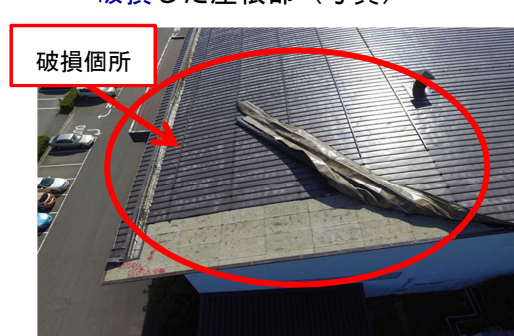
破損した屋根部（写真）
