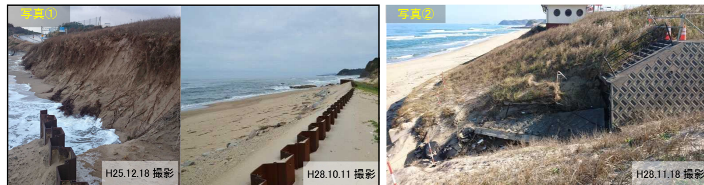
図 6.1.1 現地写真(被災状況・復旧状況)
