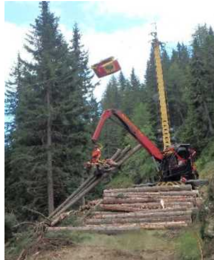
高性能架線系機械(タワーヤーダ)
