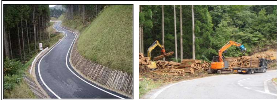
【路網ネットワークを形成する幹線となる林道の整備】 とっとり森と緑の産業ビジョンによる持続可能な森林経営の確立と、適正な森林整備の推進により森林の多面的機能の高度発揮を図るため、森林整備を効率的に行う上で不可欠な、林内路網の幹線である林道の整備を行っています。 (林道窓山線:日南町上萩山(左)整備状況、日南町新屋(右)利用状況)
