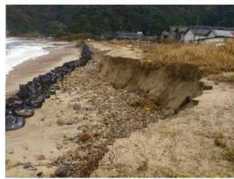
○浜がけで危険な状態
