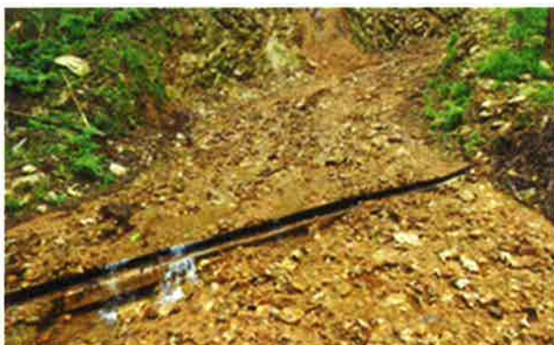
写真 土砂が堆積した横断排水工を越流する路面水
