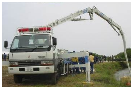
排水ポンプ車（鳥取市福部町）
