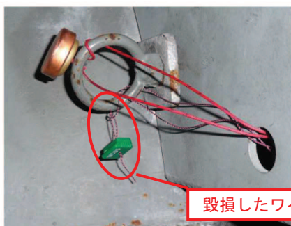
毀損した査察用封印
