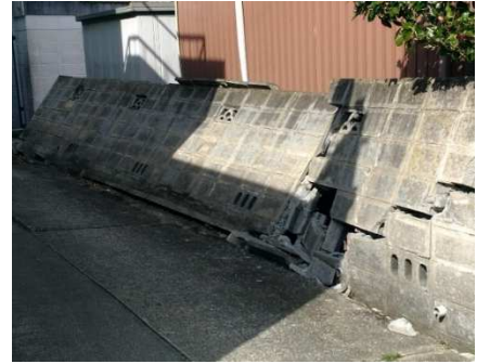
ブロック塀の傾き
