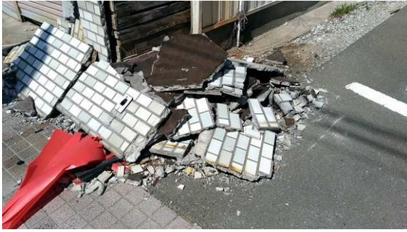
外壁タイル貼りの落下
