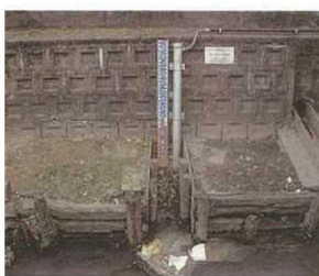
水位計設置状況
