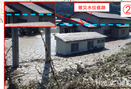
浸水解消後の流入土砂堆積状況
