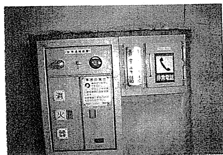
消火器・非常電話 通報装置 (押ボタン式)
