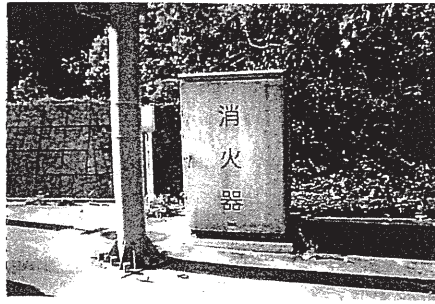
大型消火器 (鳥取側)
