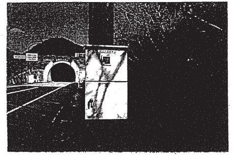
引込用開閉器函 (岡山側)
