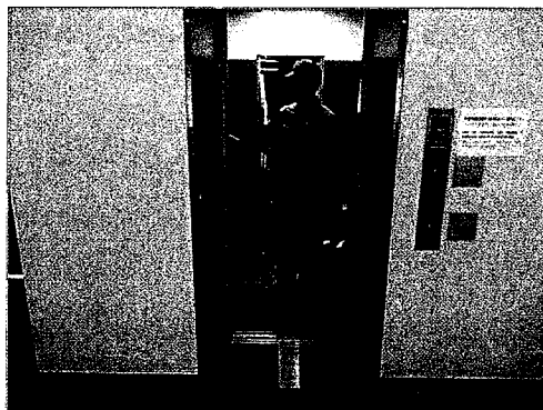
エレベーター定期点検
