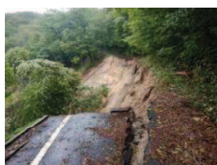
【北栗祖線（三朝町）】 路体崩壊
