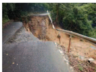
【円谷広瀬2号線（倉吉市）】 路体崩壊
