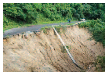
【実光福吉線（三朝町）】 路体崩壊
