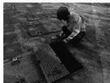
浄化槽保守点検業務
