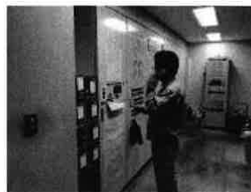
消防用設備保守点検
