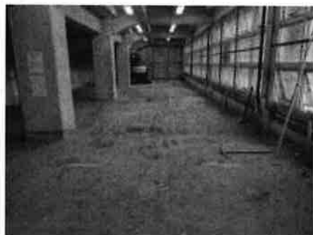
野球場屋内ブルベン 修繕前
