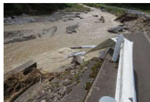
[取水箇所の崩落<鳥取市河内>]
