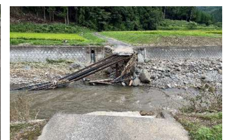
[農道橋の流出<八頭町落岩>]
