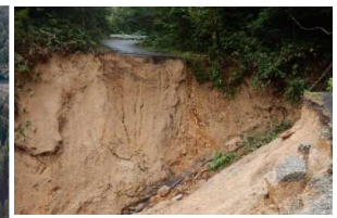
[林道の崩落<三朝町福吉>]
