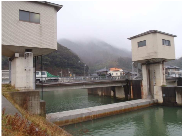
調節ゲート全景（全閉状態）
