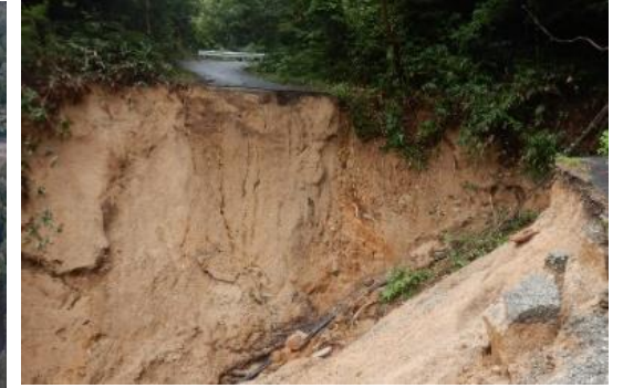
[林道の崩落<三朝町福吉>]
