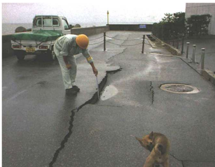
写真4：外周道路の亀裂と陥没 (参考文献④)
