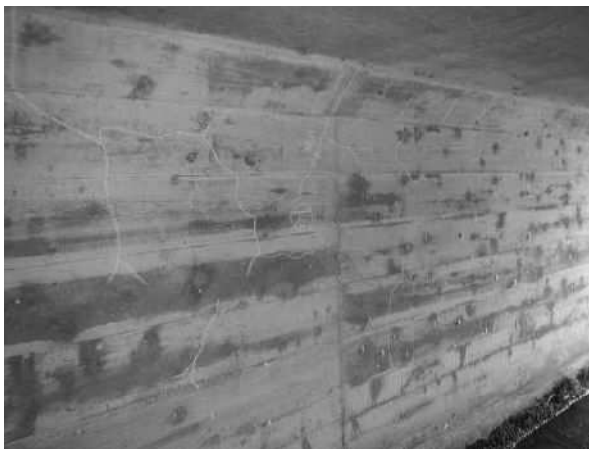
ひびわれ間隔（区分：密）
