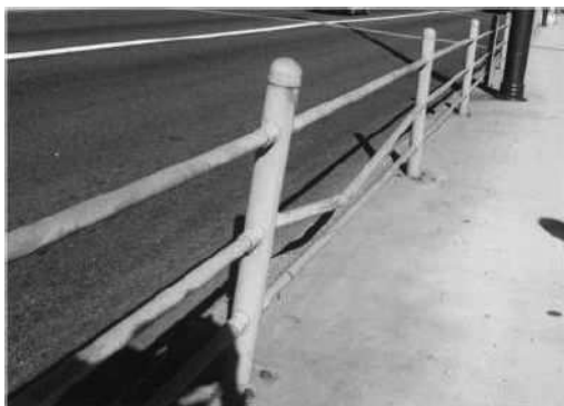
部材が局所的に変形している。
