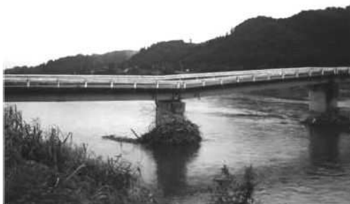
下部工の異常によって、上部工に異常なたわみが生じている。
