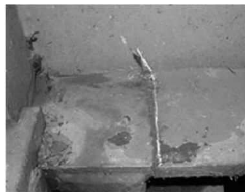
亀裂が生じている。
