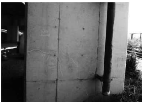
軽微なひびわれが生じている。
