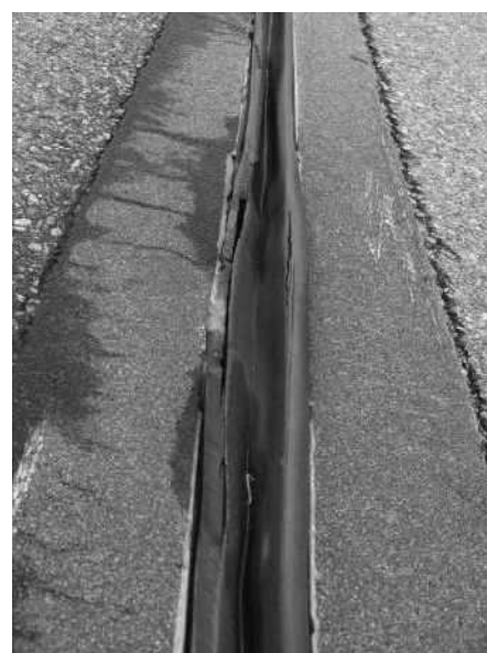
(ゴム) ひびわれが生じている。
