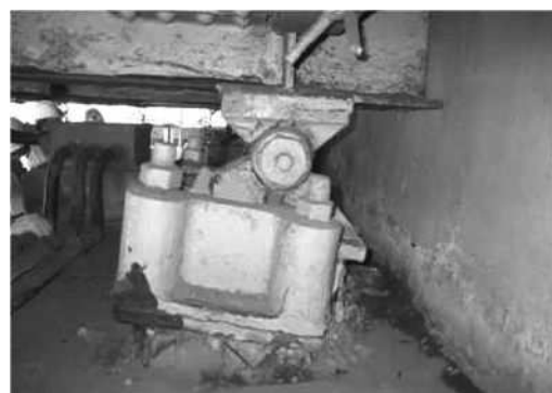
支承が沈下・傾斜している。
