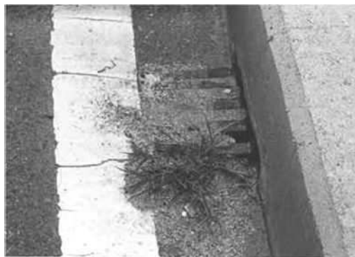
排水桝に土砂詰りが生じている。
