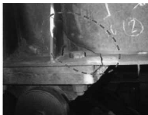
亀裂が生じている。
