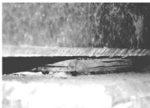
(ゴム) ひびわれが生じている。
