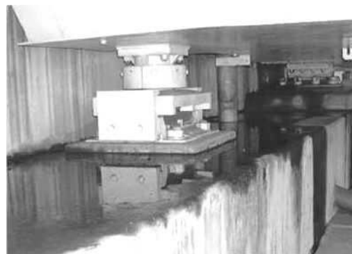
橋座に滞水がある。
