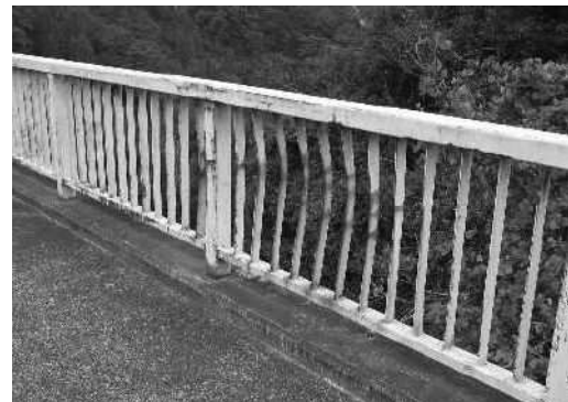
部材が局所的に変形している。
