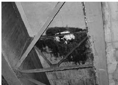
コンクリート塊が抜け落ちている。
