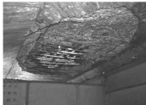
コンクリート塊が抜け落ちている。
