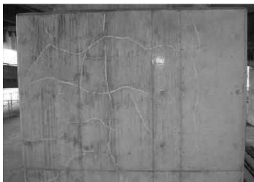
軽微なひびわれが生じている。
