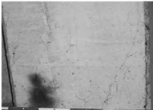
錆汁を伴う漏水が生じている。
