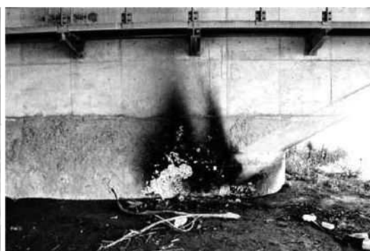
たき火による損傷
