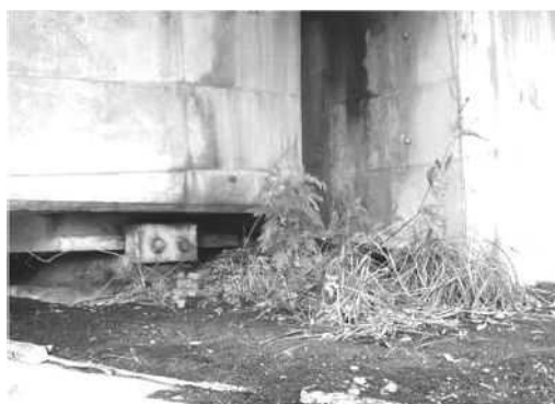
支承周辺に土砂詰りが生じている。
