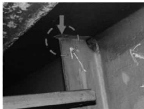
塗膜割れが確認出来る。
