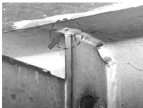
塗膜割れが確認出来る。
