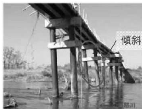
パイルベント
