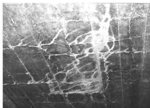
ひびわれ間隔が格子状に発生。 ひびわれ幅は 0.2mm 以上が主である。 部分的な角落ちが生じている。 漏水・遊離石灰が確認できる。
