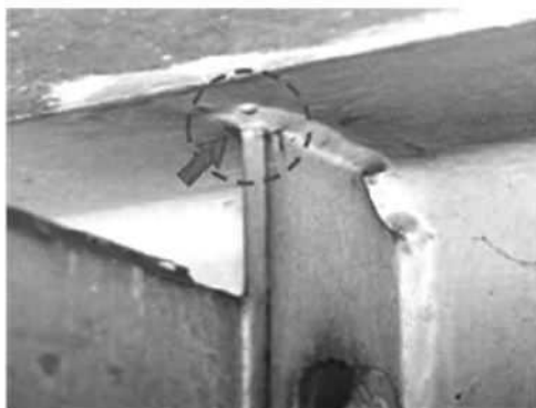
塗膜割れが確認出来る。
