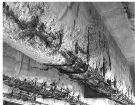
塩害による鉄筋腐食の場合、鉄筋腐食が加速度的に進行する。
