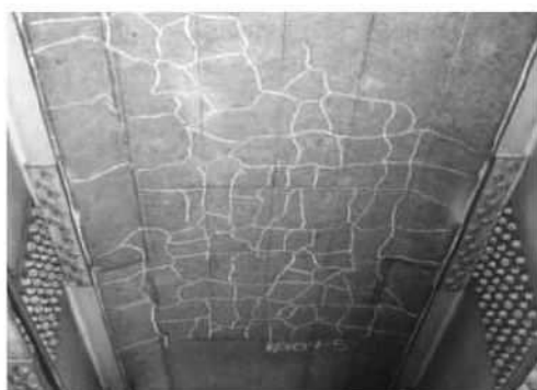
ひびわれ間隔が 0.2m 以下で格子状に発生。 ひびわれ幅は 0.2mm 以上が主で連続的な角落ちが生じている。
