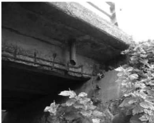
コンクリート剥離や鉄筋露出・著しい腐食が生じる。
