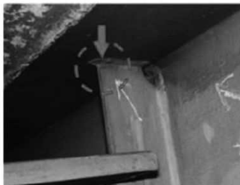
塗膜割れが確認出来る。
