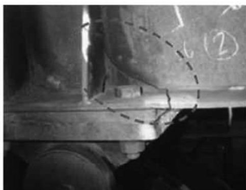
亀裂が生じている。
