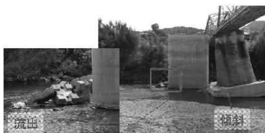
平成30年に生じた洗掘被害
