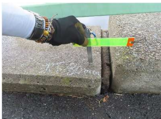
沈下が生じている。
