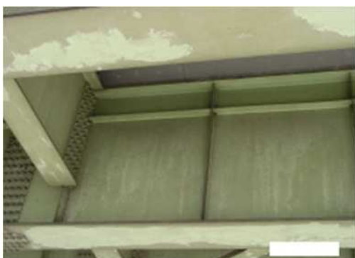
最外層の防食皮膜が変色している。
