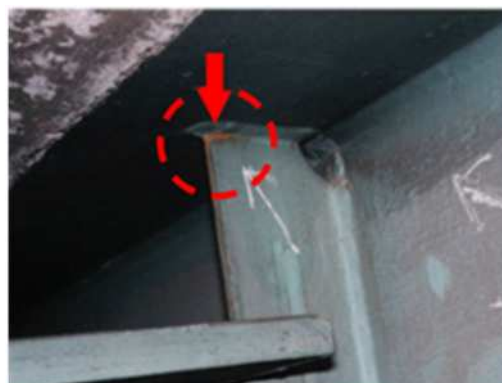
塗膜割れが確認できる。
