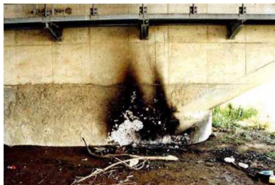
たき火による損傷
