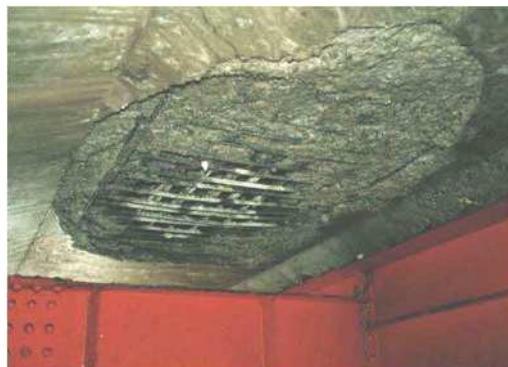
コンクリート塊が抜け落ちている。
