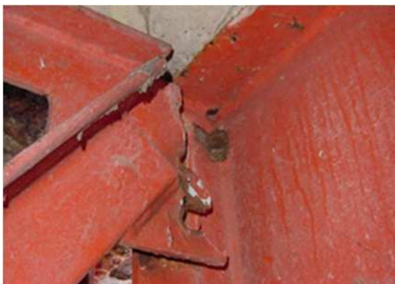
対傾構が破断している。
