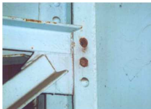
脱落しているボルトの数が多い。
