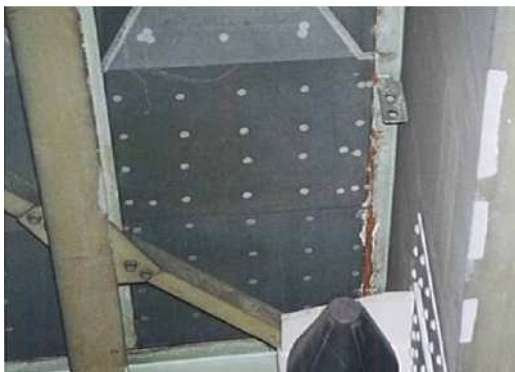
うきは発生していないものの、シール部が一部剥離し、錆及び漏水が見られる。
