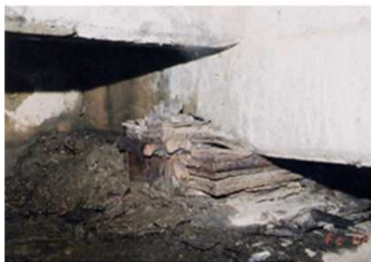
パターン 2 著しい腐食が生じている。
