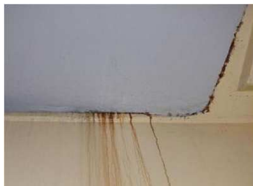
錆汁を伴う漏水が生じている。
