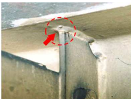
塗膜割れが確認できる。
