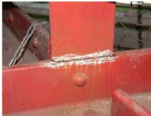
吊り材が破断している。
