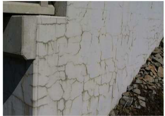
顕著なひびわれが生じている。
