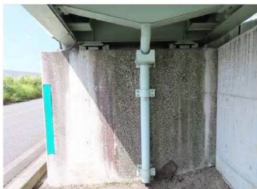
伸縮装置から漏水がある。
