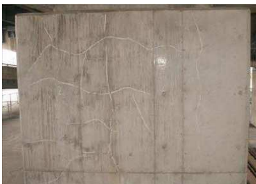
軽微なひびわれが生じている。
