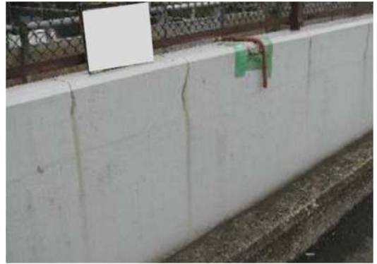
軽微なひびわれが生じている。
