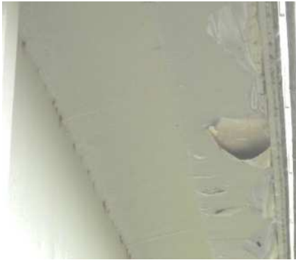
塗膜の剥離が生じている。
