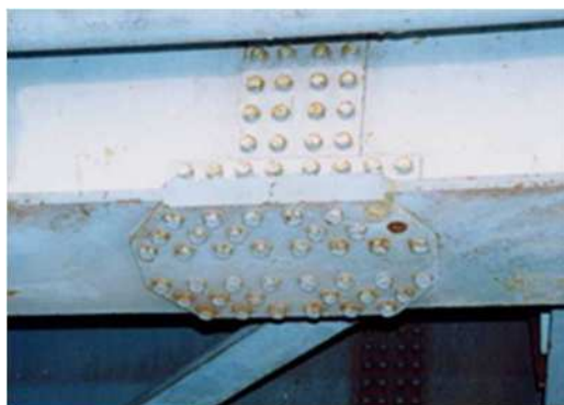
脱落しているボルトの数が少ない。
