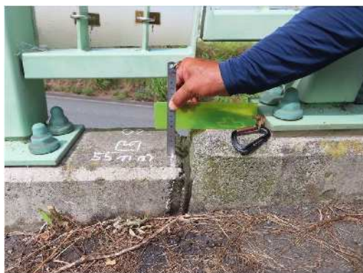
沈下が生じている。
