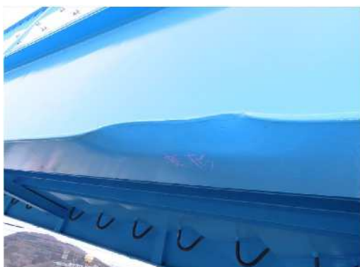
部材が局所的に変形している。
