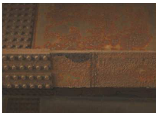
錆は層状の剥離がある。
