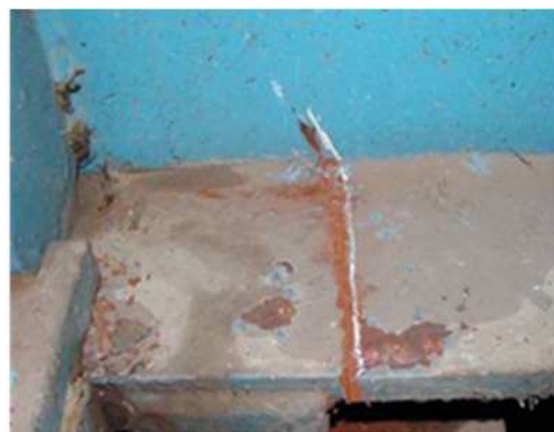
亀裂が生じている。
