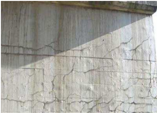
顕著なひびわれが生じている。
