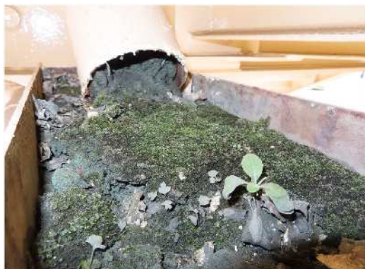
排水桝に土砂詰りが生じている。
