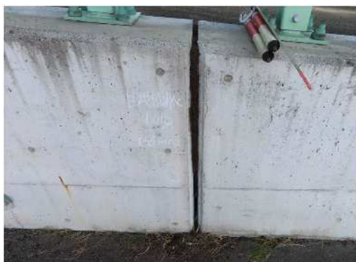
(コンクリート) 漏水により変色している。
