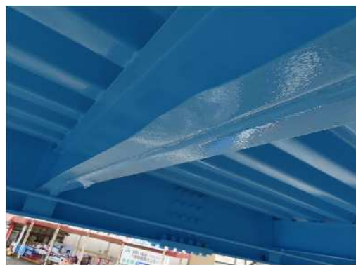
部材が局所的に変形している。
