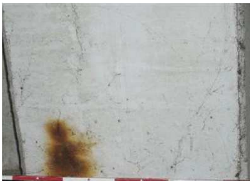
錆汁を伴う漏水が生じている。
