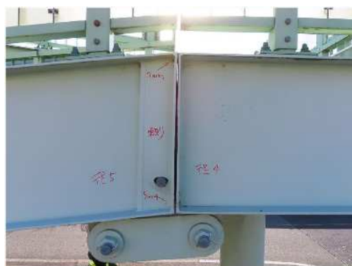
主桁同士が接触している。
