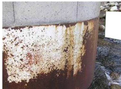
顕著な錆が生じている。
