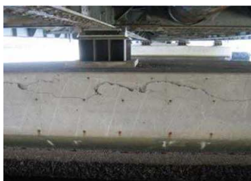
広範囲で剥離が生じている。
