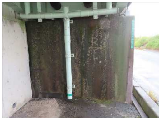
伸縮装置から漏水がある。
