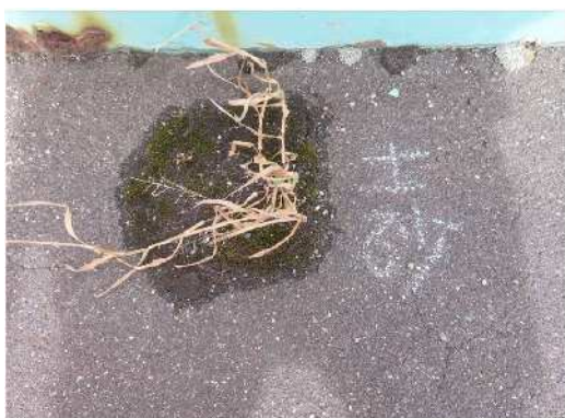
排水桝に土砂詰りが生じている。
