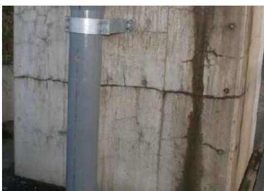
顕著なひびわれが生じている。
