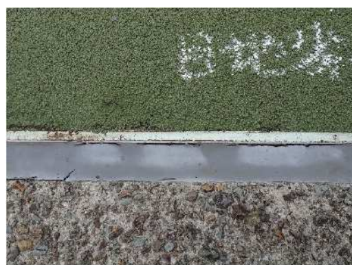
(ゴム) シーラ材に劣化が生じている。
