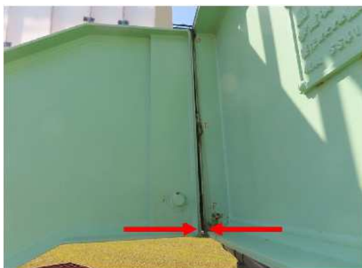
主桁と階段部が接触している。
