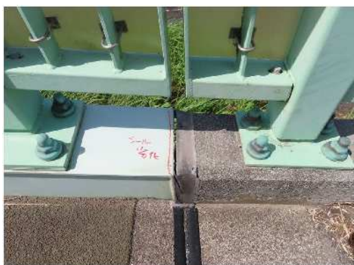
(ゴム) シーラ材に劣化が生じている。
