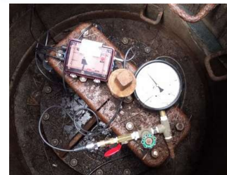
遠隔水圧監視システム
