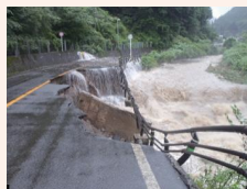
▲国道373号(智頭町福原) 護岸崩壊
