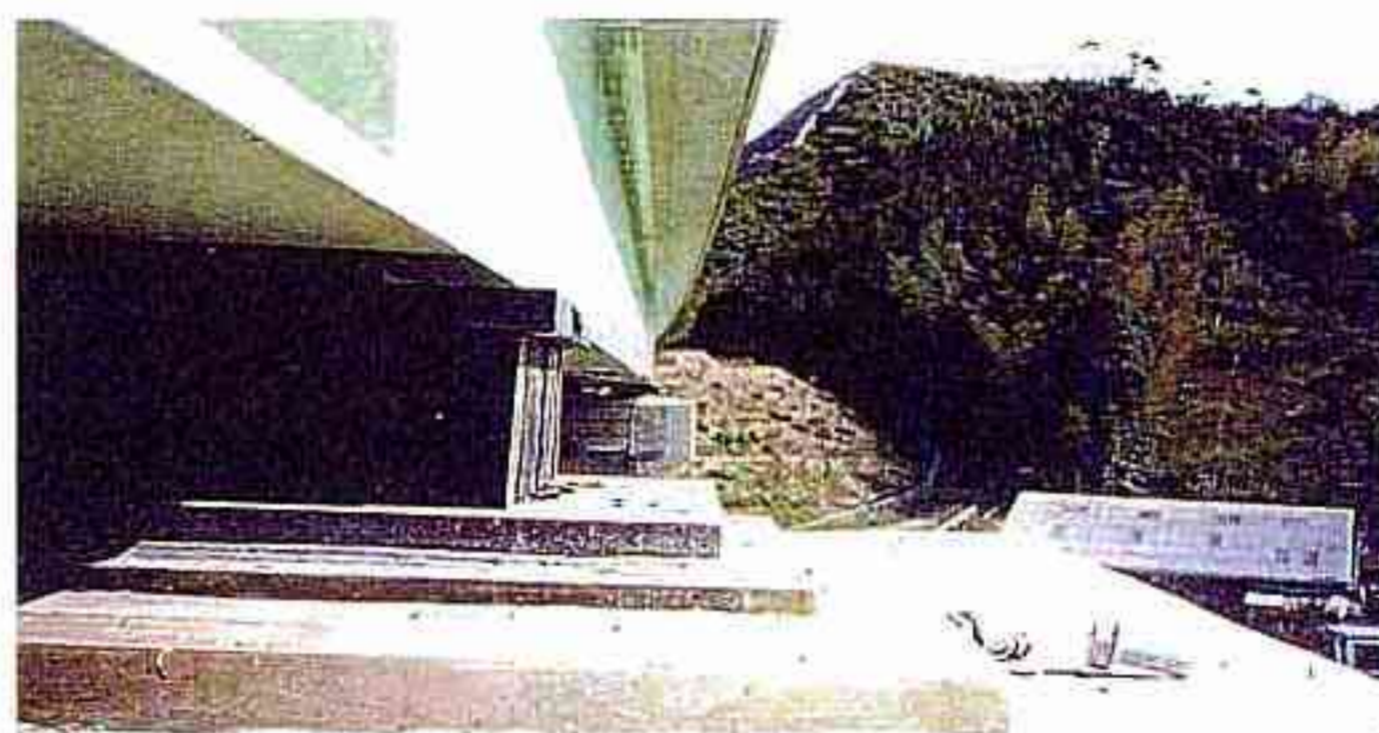
写真 4-14 耳桁部支承のサイドブ ロックが破損し、橋脚外 へ落下した
