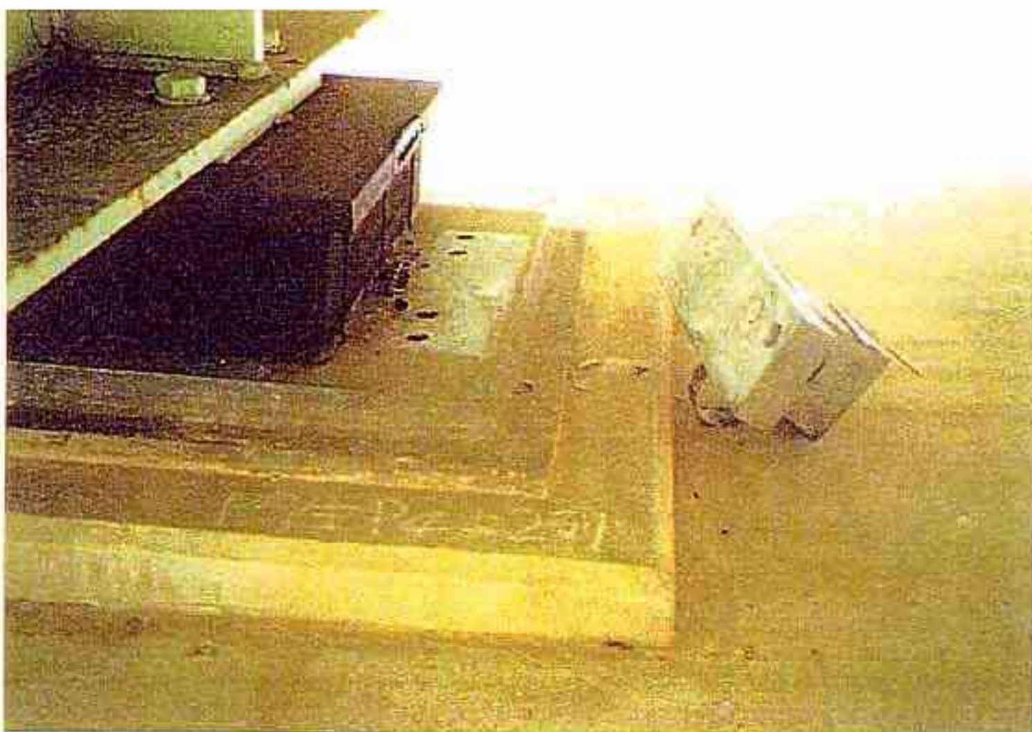
写真 4-13 サイドブロックの破損
