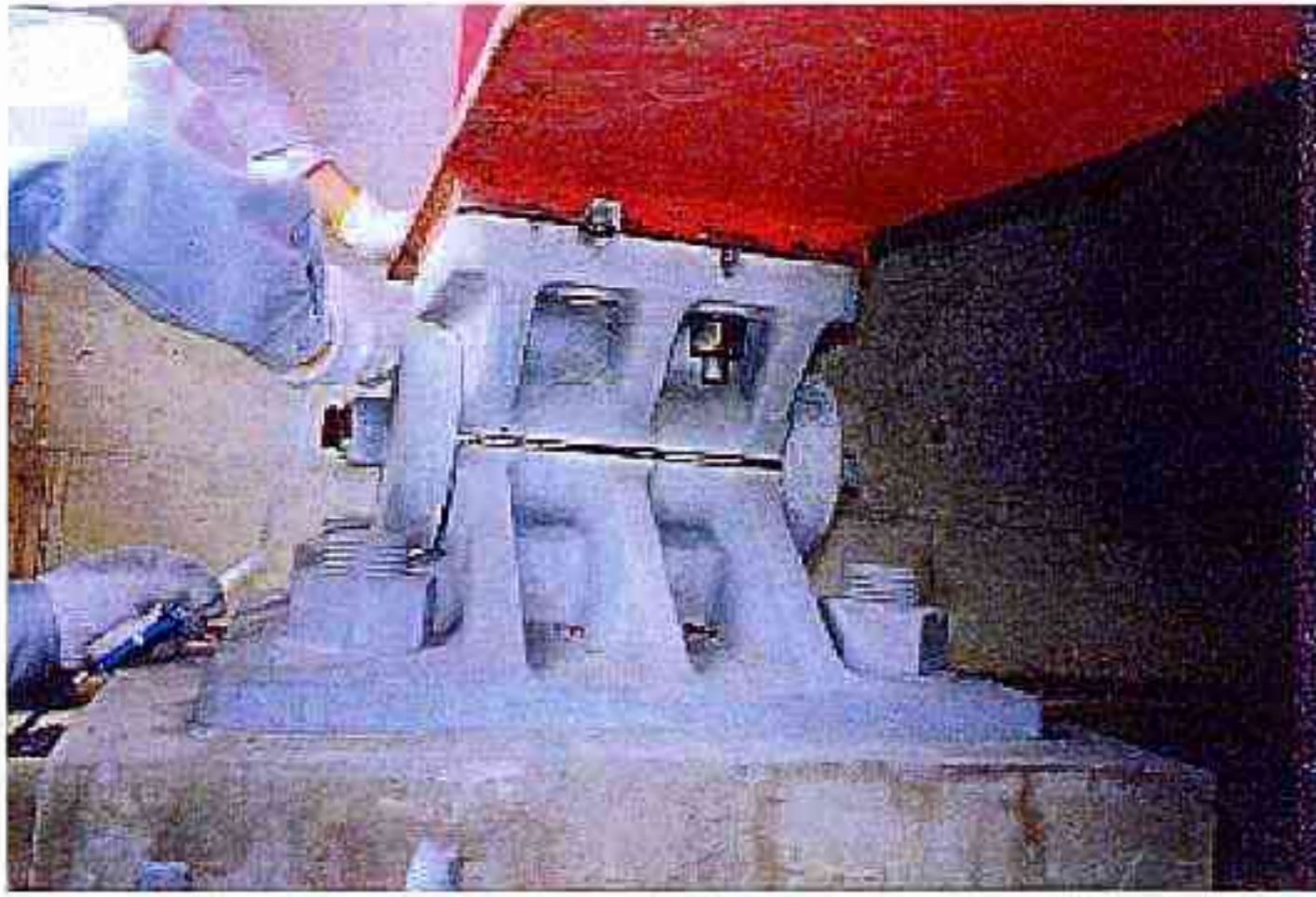
写真 4-1 セットボルトの破断 写真は復旧時の模様
