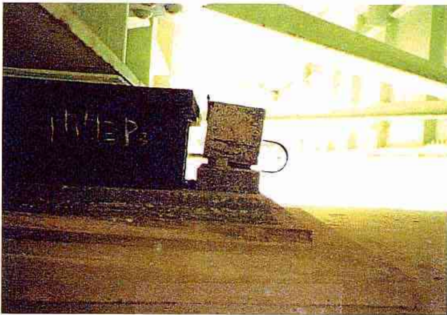
写真 4-12 サイドブロックの変形 (橋軸直角方向への傾倒)
