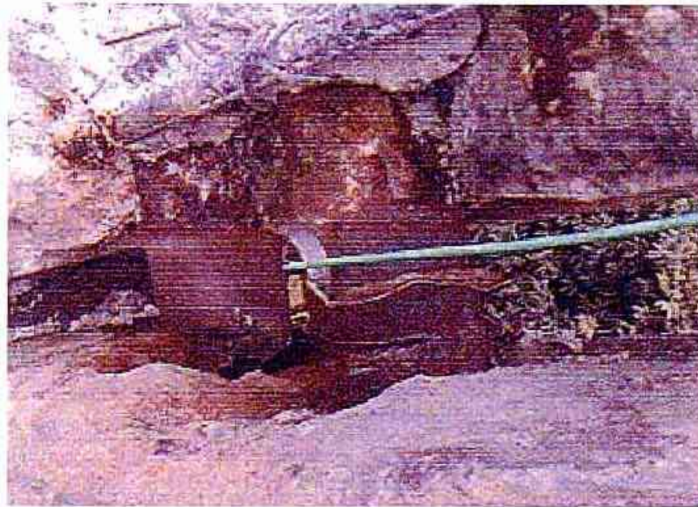
管路損傷部拡大
