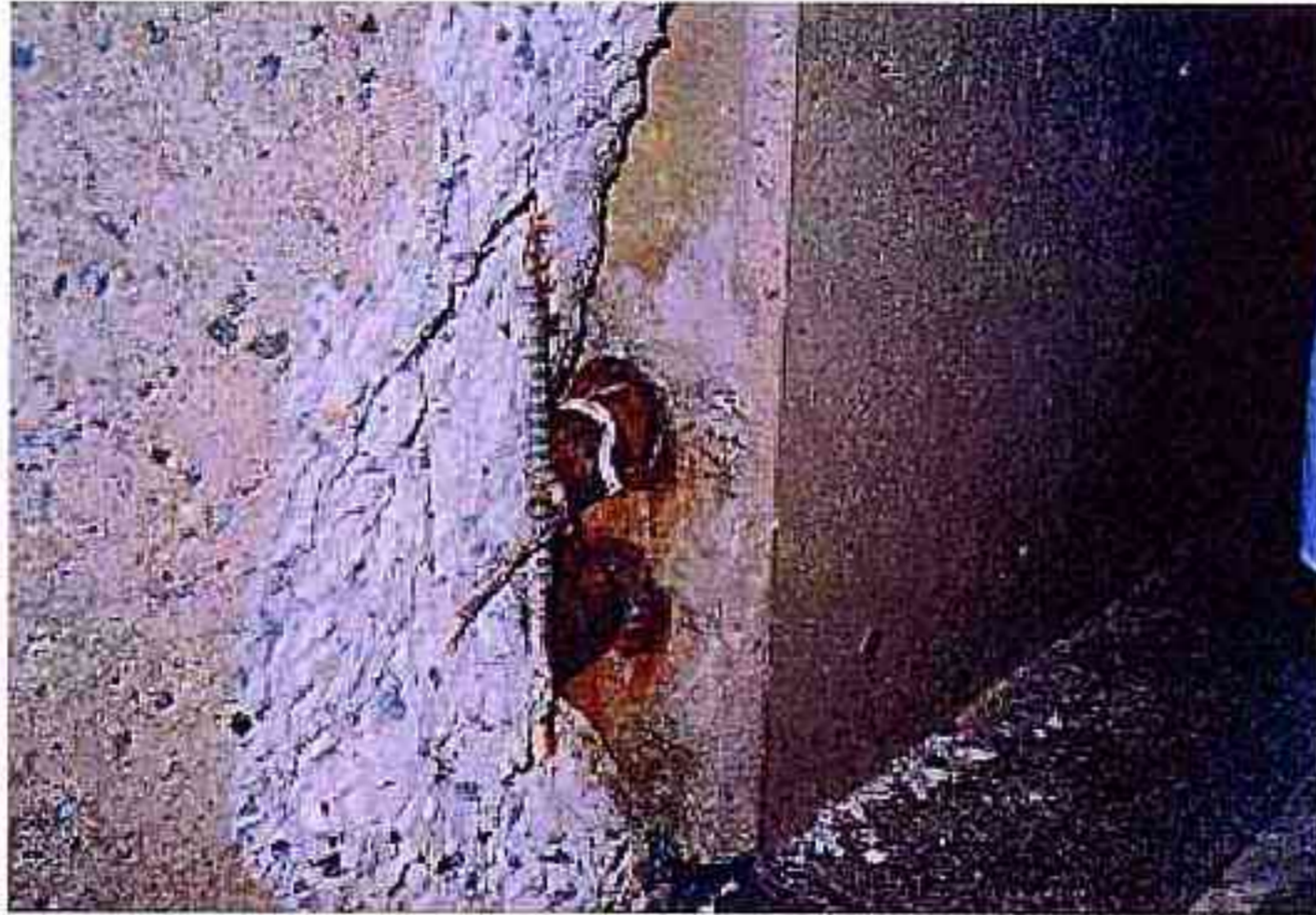
D板制御ケーブル断線箇所
