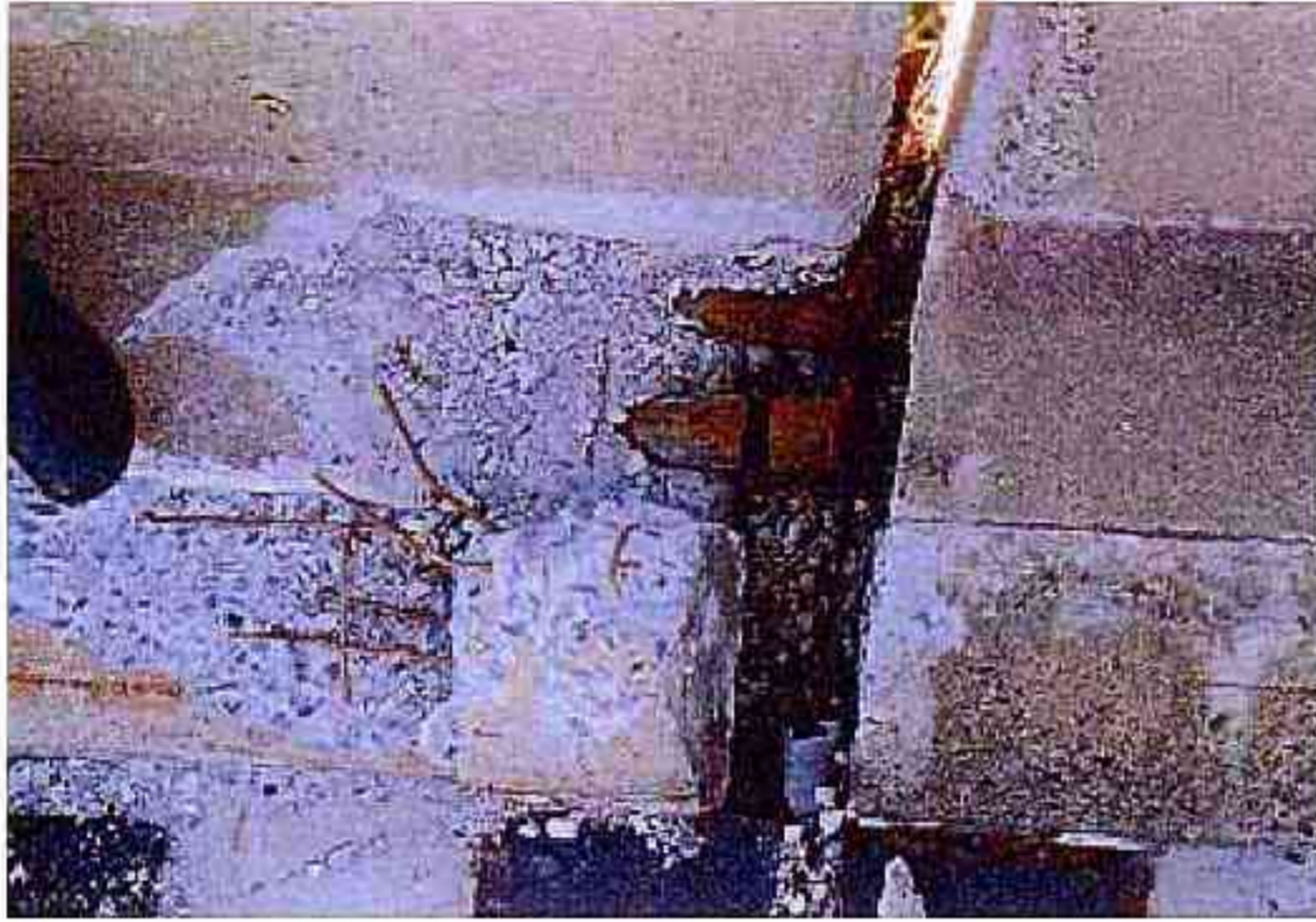
通信幹線断線箇所
