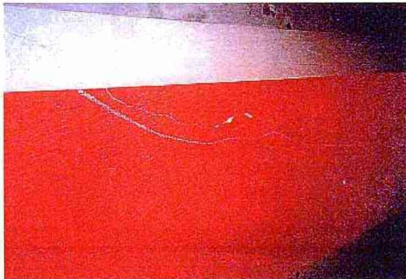
地震の影響によると思われる側壁部の新しいひびわれ
