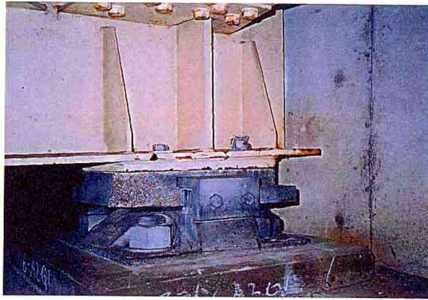
上杓の破断、セットボルト破断（被災ランク：A） （米子自動車道 清山川橋）
