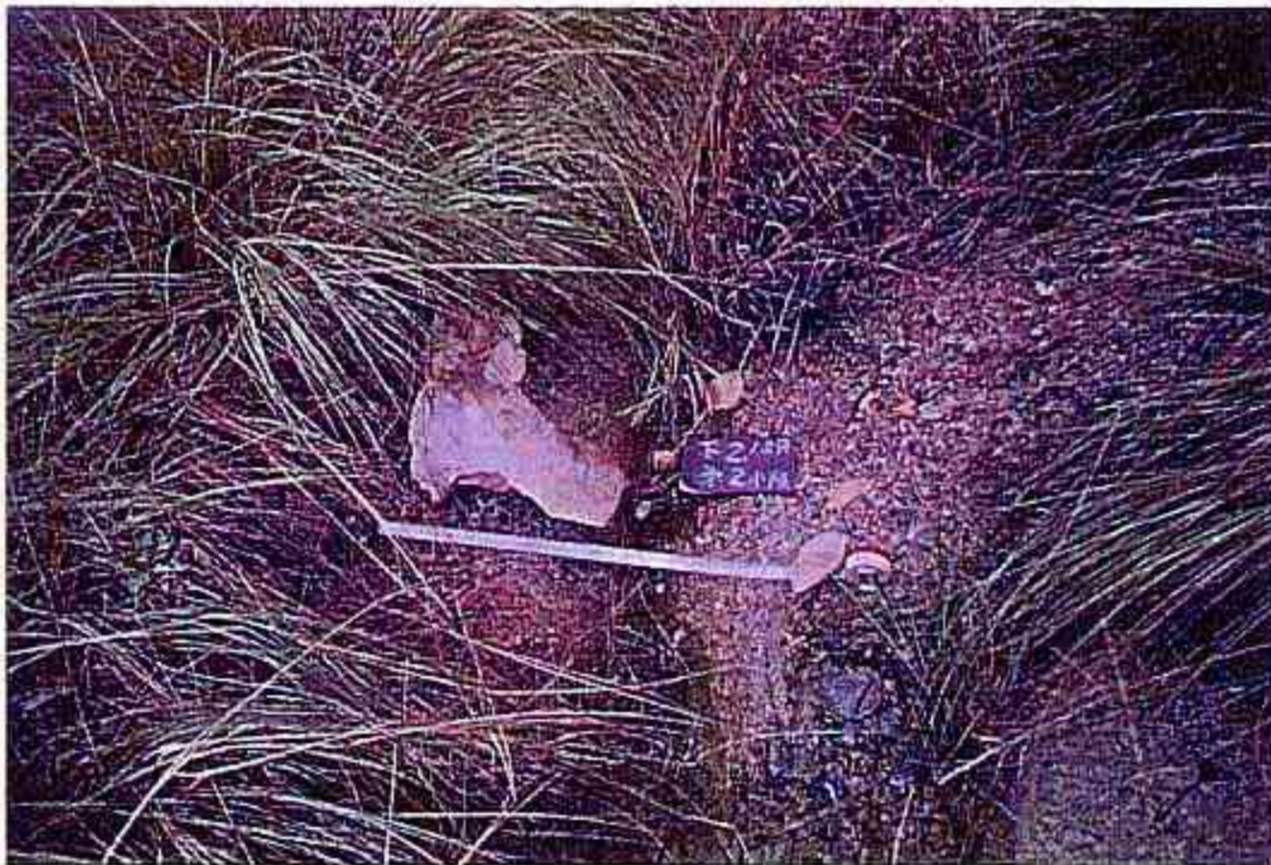
風化肌落部 不安定な礫の落下 (ランク C) (米子道路 切土部 KP2.1)
