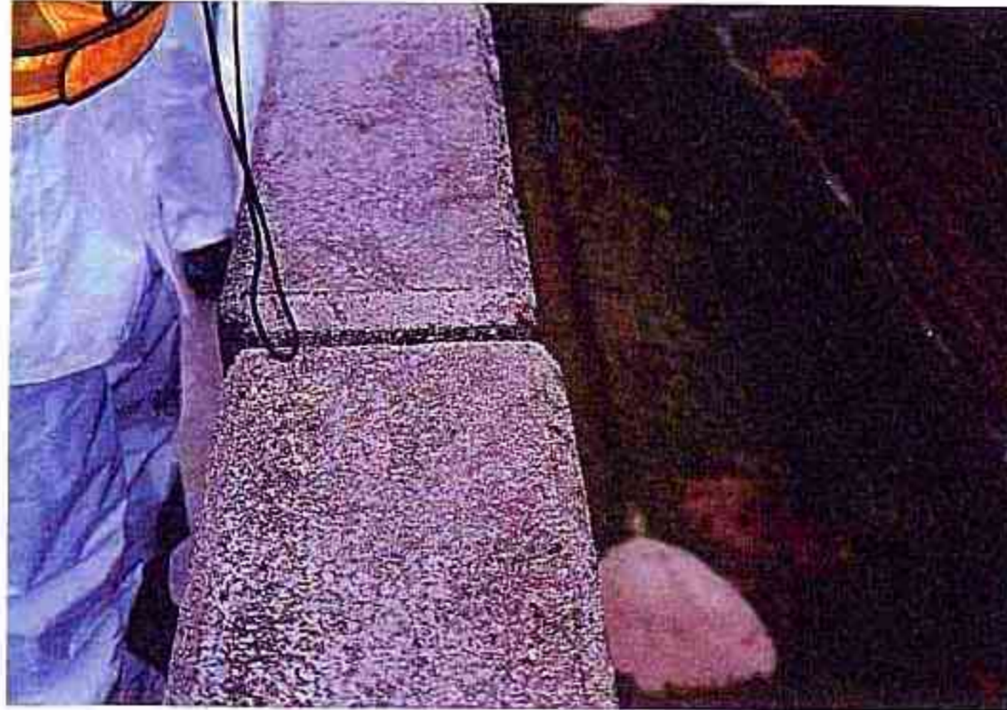
橋軸直角方向の変形（高欄部撮影）（被災ランク：D） （米子自動車道 別所川橋）
