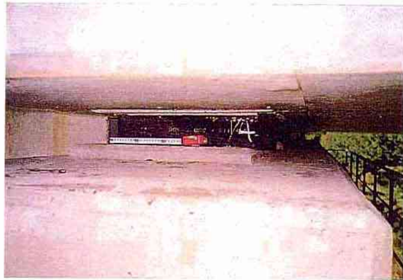
ゴム沓のズレ（約3 cm）（被災ランク：C） （米子自動車道 旭川橋）
