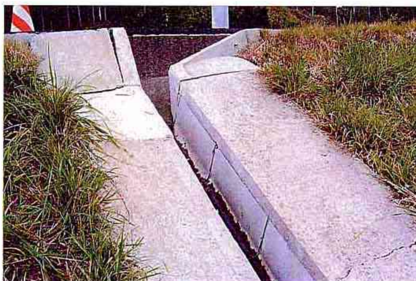
縦溝シールコンクリートのクラック（ランクD） （安来道路 盛土部 KP306.14）
