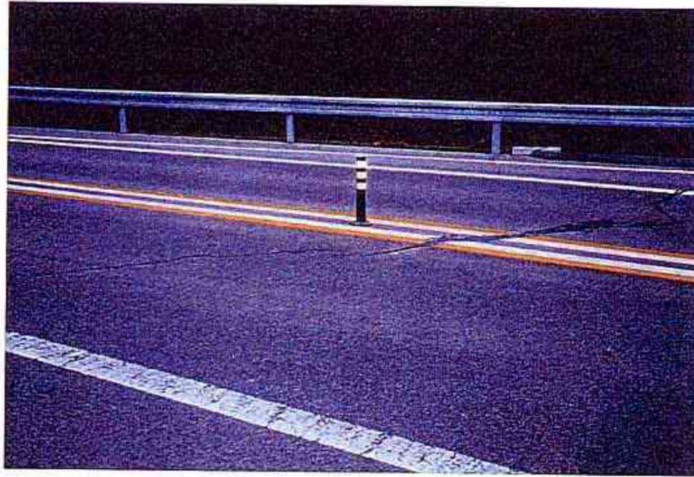
安来道路 路面クラック (ランクC) (門生高架橋付近)
