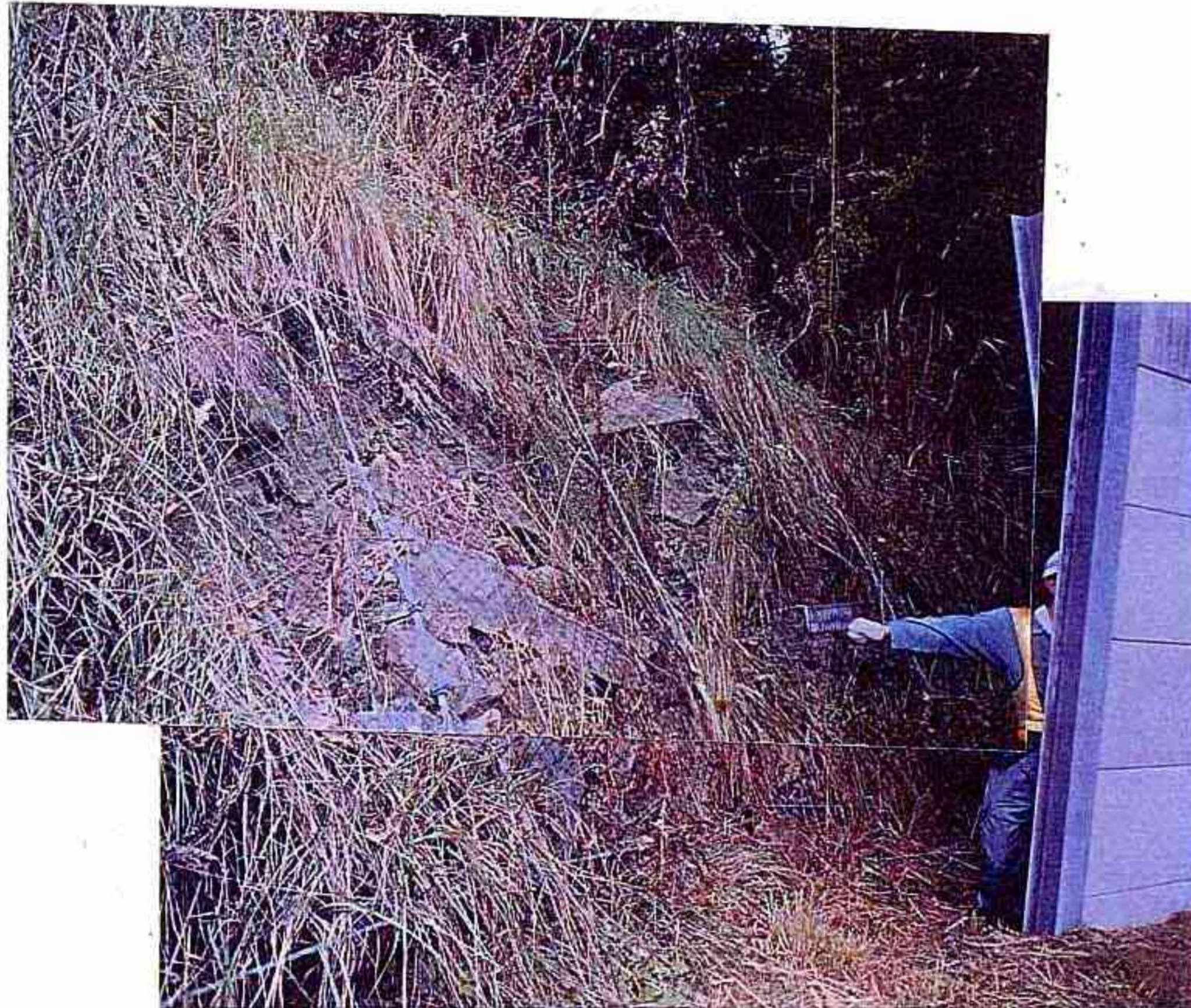
崖錐堆積層の崩落 6.0×3.0 (ランク B) (中国自動車道 切土部 KP214.2)
