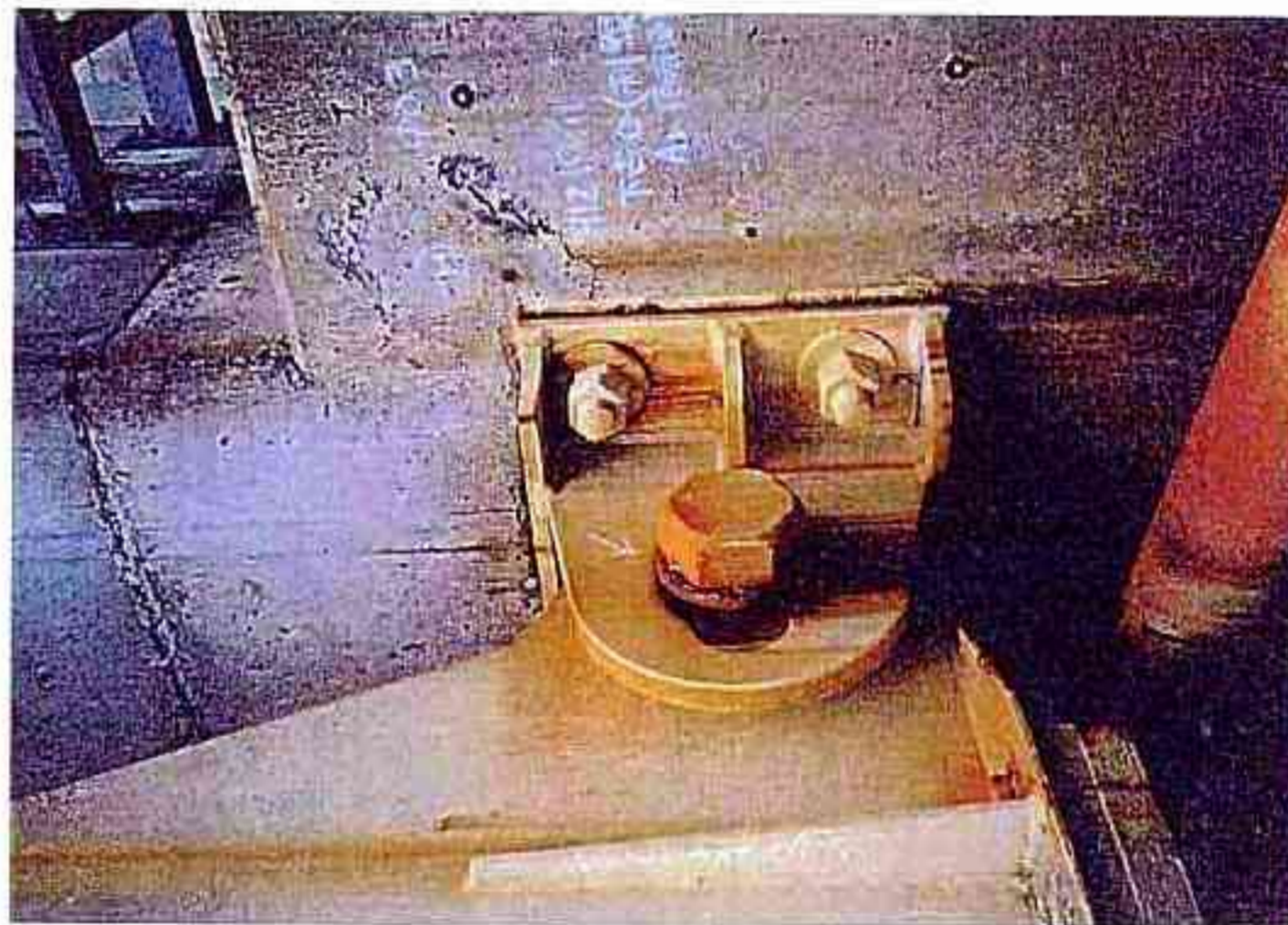
落橋防止装置アンカー周りの剥離（被災ランク：C） （中国自動車道 下古谷橋）
