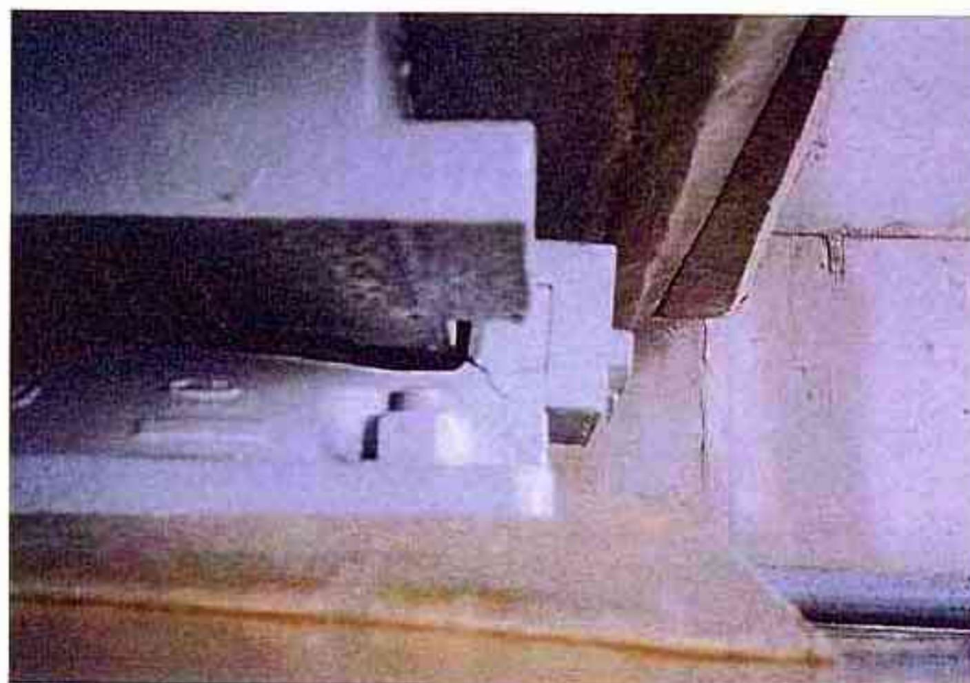
サイドブロックに発生したクラック（被災ランク：C） （岡山自動車道 有漢高架橋）
