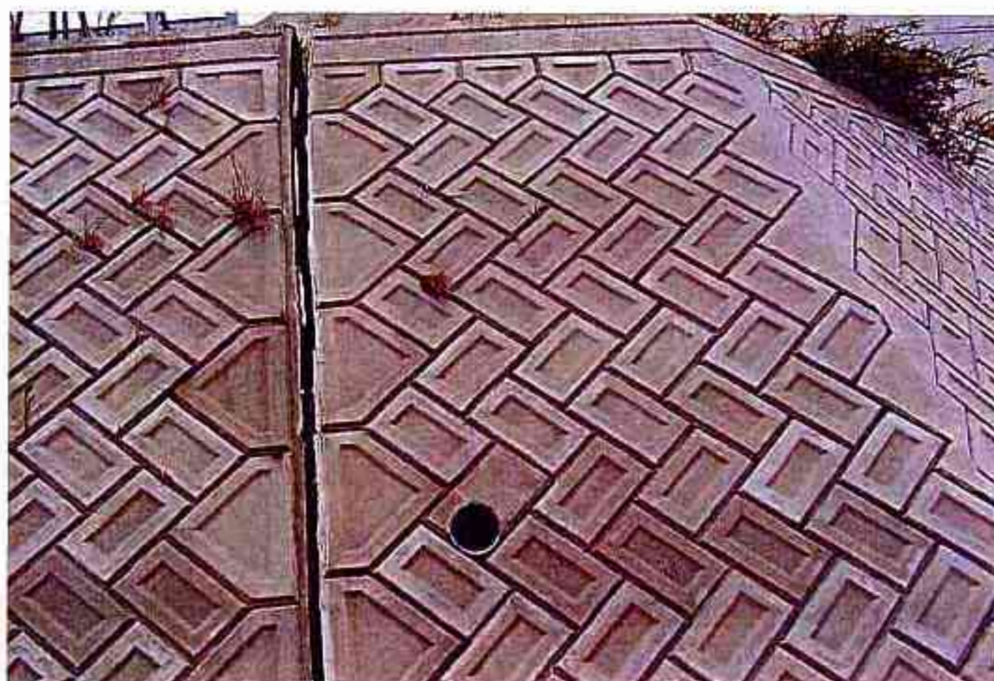
ブロック積みの目地の開き（ランクD） （安来道路 盛土部 KP305.78）
