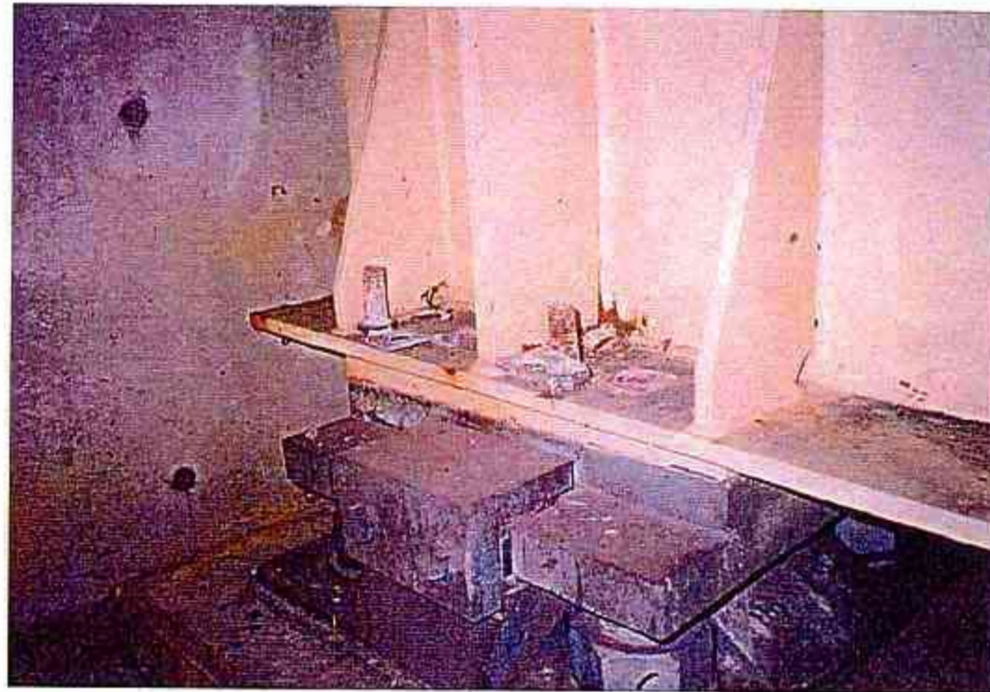
セットボルトのゆるみ（被災ランク：C） （米子自動車道 清山川橋）
