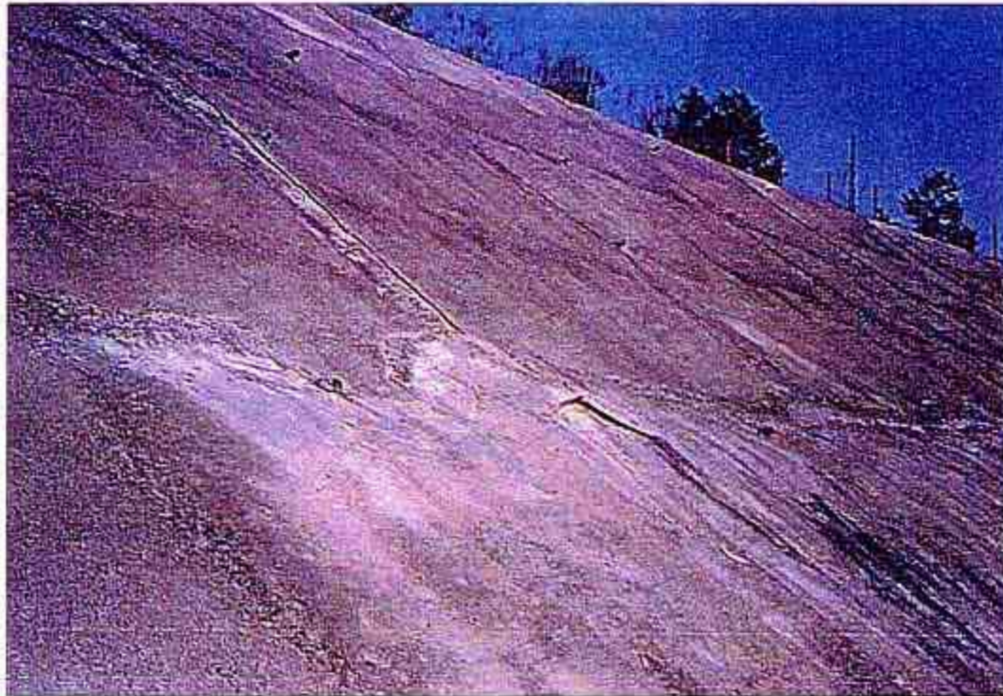
吹付けコンクリートのクラック (ランク D) (安来道路 切土部 KP311.4 安来 IC 内)
