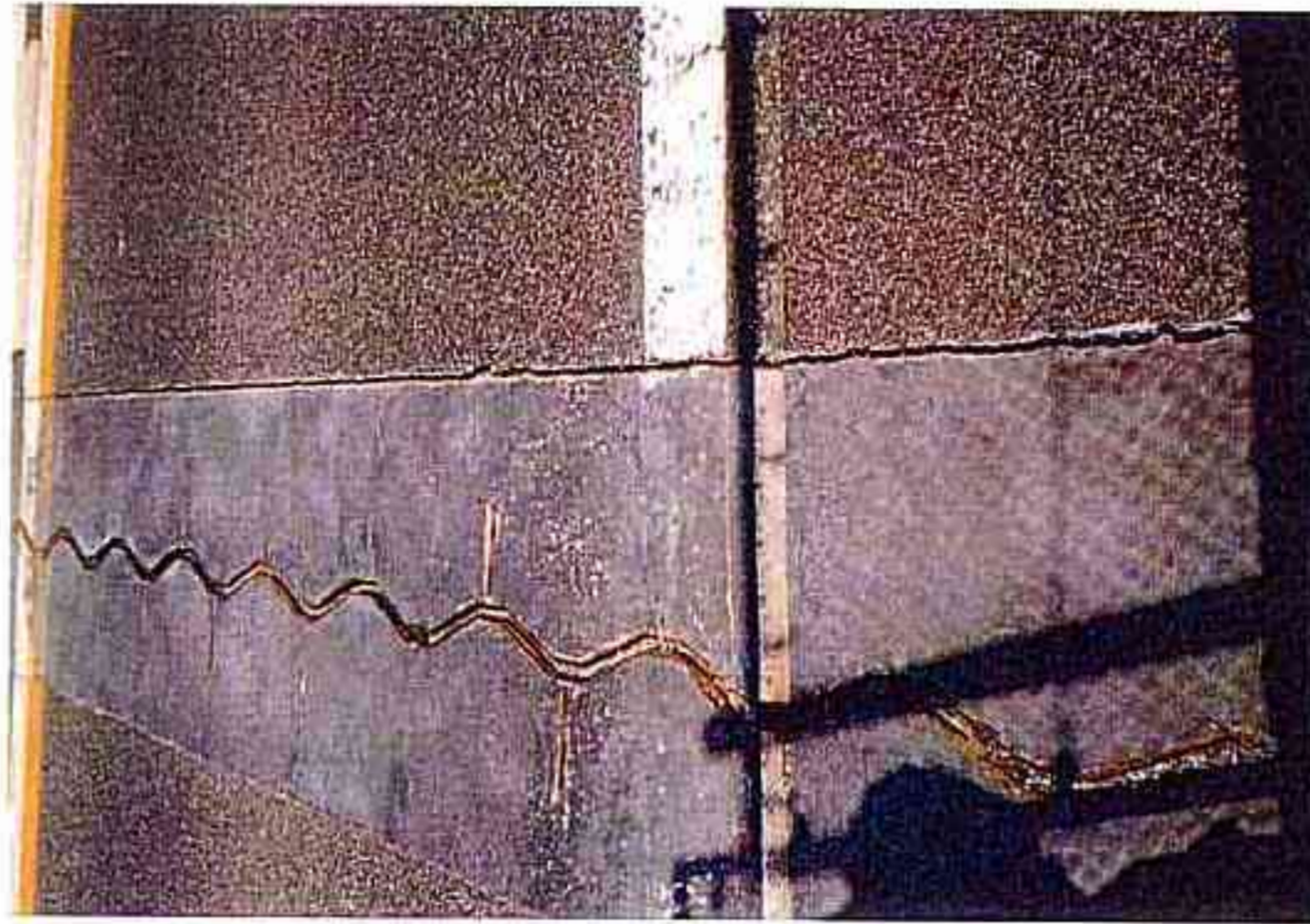
伸縮装置後打ち材と舗装部の隙間（被災ランク：D） （安来道路 御茶屋川橋）
