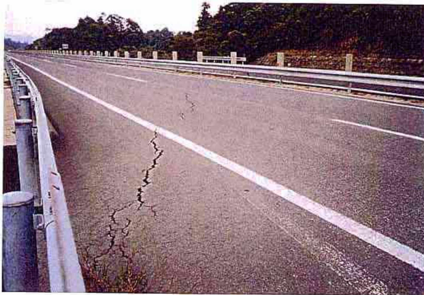
米子道路 路面段差・クラック (ランクC) (溝口～米子間)
