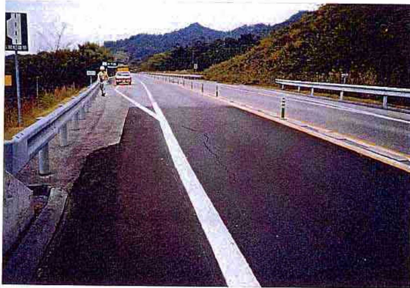
安来道路 路面クラック (ランクC) (KP307.2 塩谷橋 A1 付近)
