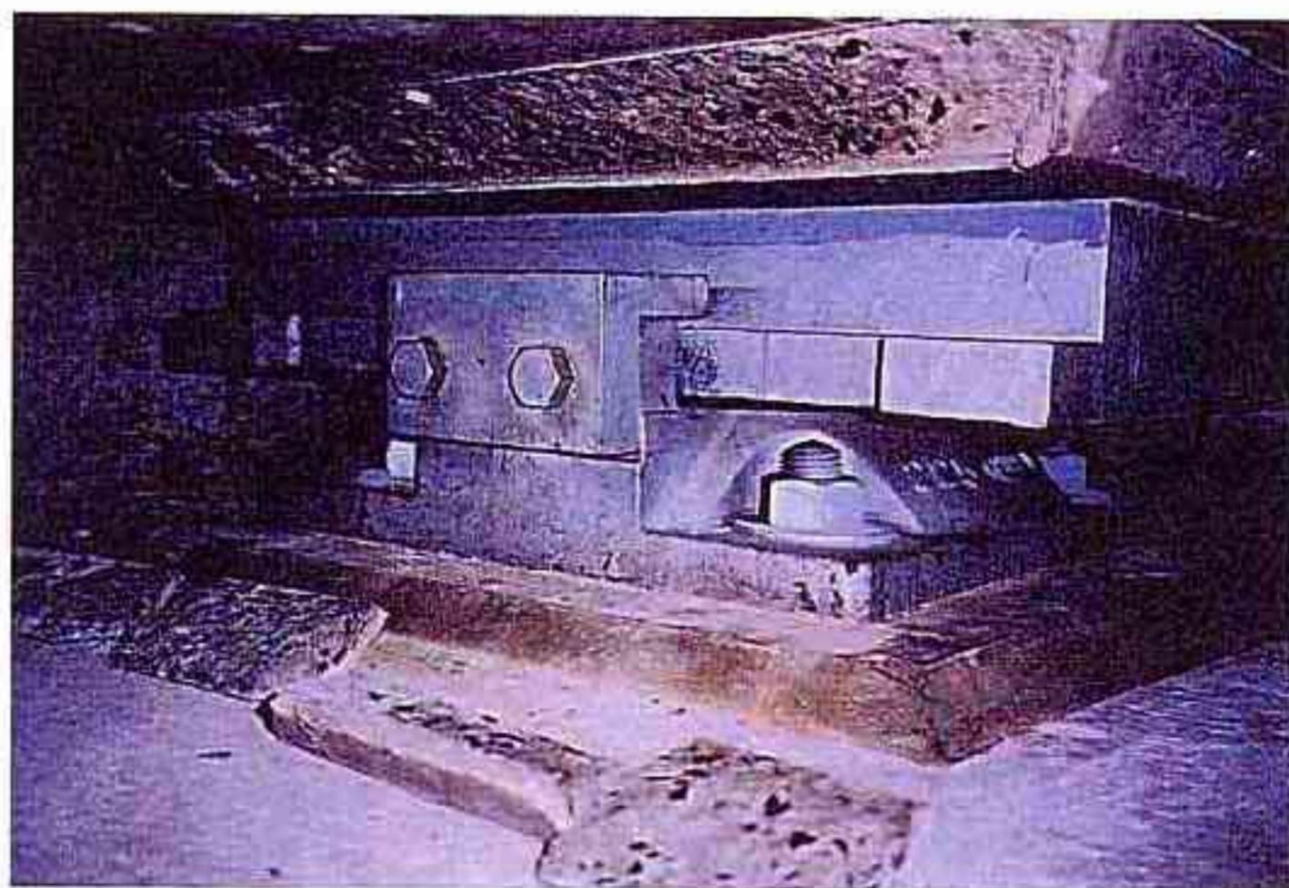
レアーコンクリートの剥離（被災ランク：D） （米子自動車道 白水川橋）
