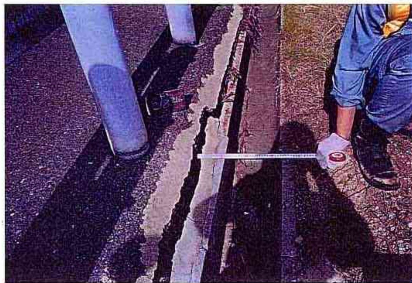
のり肩の沈下・舗装部と側溝の段差・開き (ランク C) (中国自動車道 片切片盛部 KP218.2)
