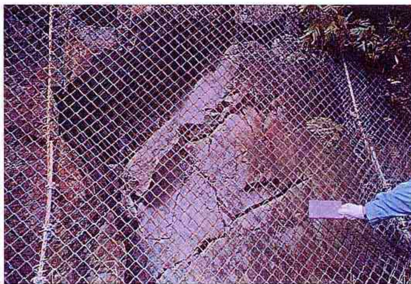
基岩の亀裂 (ランク B) (中国自動車道 切土部 KP214.2)
