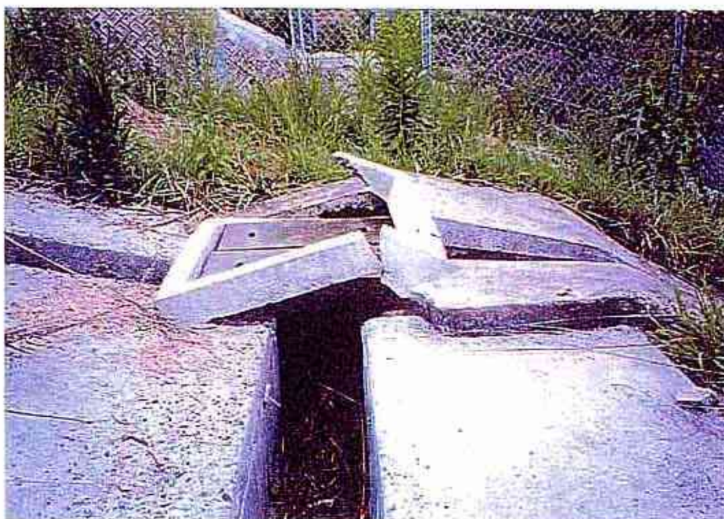
集水柵の圧壊（ランクD） （安来道路 盛土部 KP308.0）
