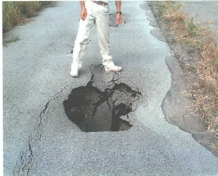
写真-2 作業道路に生じた陥没
