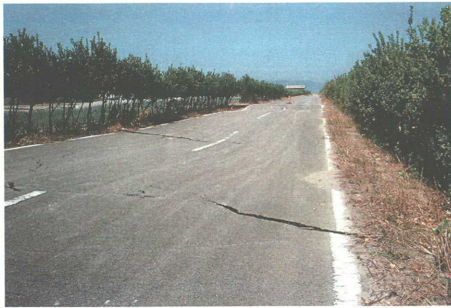
写真-1 道路面の波打ちと亀裂
