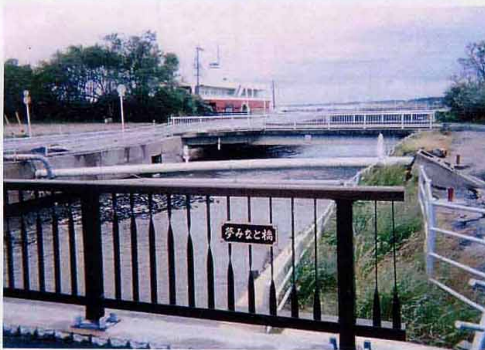
写真3.1 竹ノ内工業団地の配水管添架の被災
