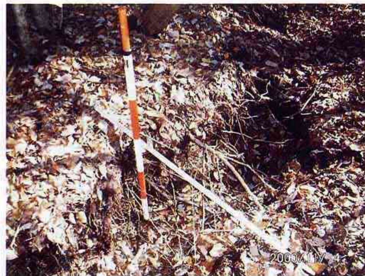
日南町役場裏山のクラック
