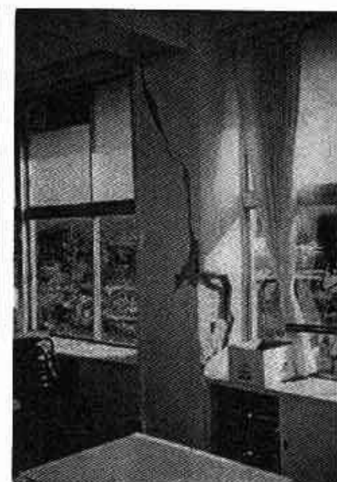
写真1(c) RC柱のせん断破壊
