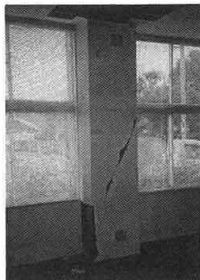
写真3(b) RC柱のせん断破壊
