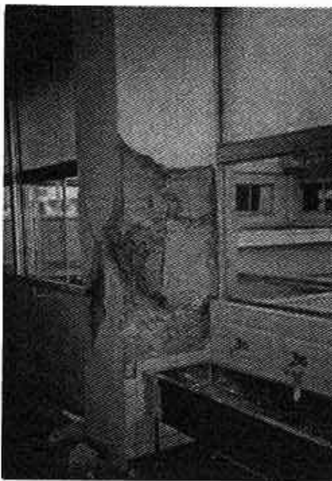
写真1(b) RC柱のせん断破壊
