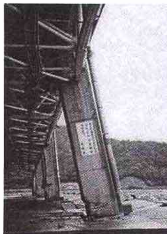
写真6(a) 地盤の側方流動による被害
