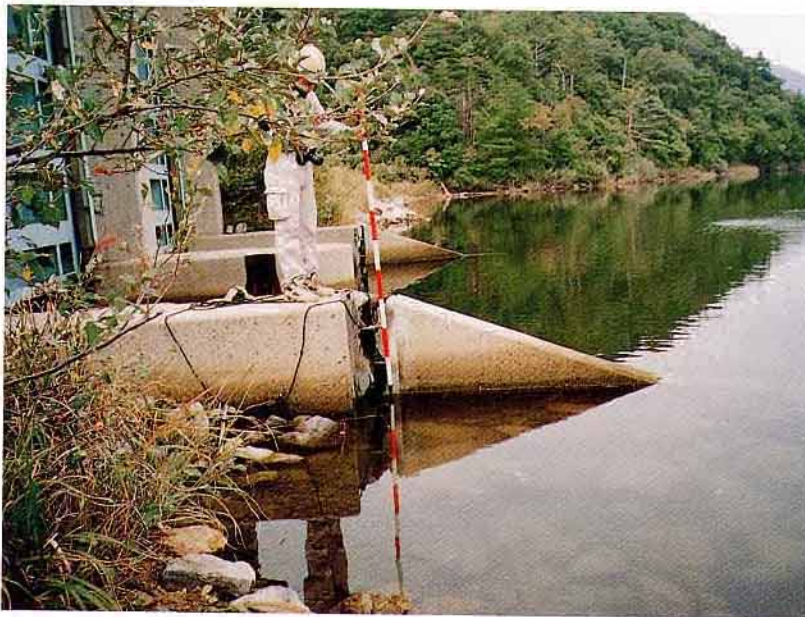
⑦-3 本庄排水機場吐出ゲート ：美保関町万原 側方流動、地盤沈下により樋門翼壁部継ぎ目が破損したのと考えられる。
