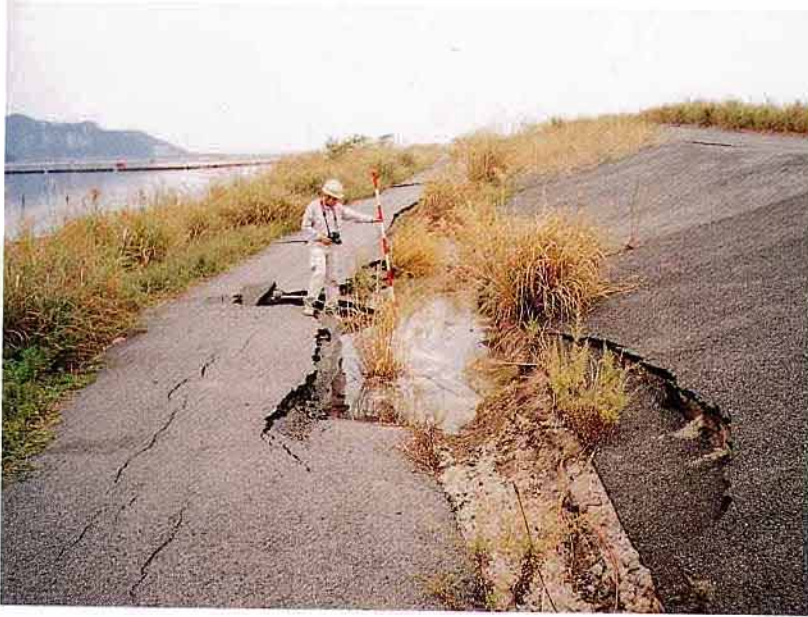
⑦-2 本庄干拓堤防：美保関町万原 本庄排水機場南の干拓堤防（外海側）が陥没した。液状化が主たる原因と考えられる。
