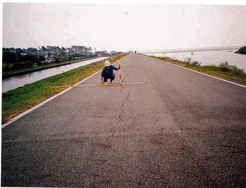
⑧ 日野川左岸 0K600 付近 ：米子市皆生新田 堤防天端に1条の縦断亀裂が2箇所見られるが、被害は軽微である。
