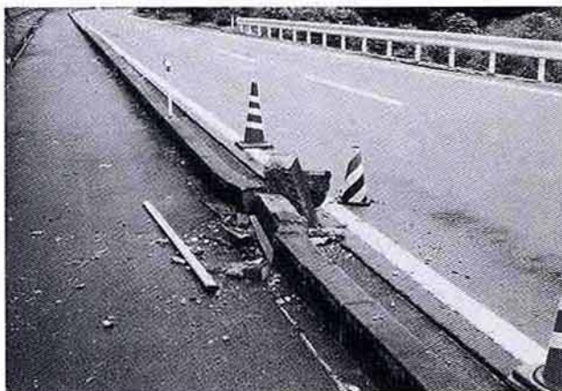
写真1 国道180号線沿いで見られた歩道の縁石の圧縮変形
