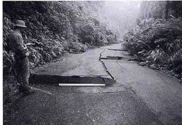
写真2 鎌倉山グリーンライン路面の雁行する圧縮変形
