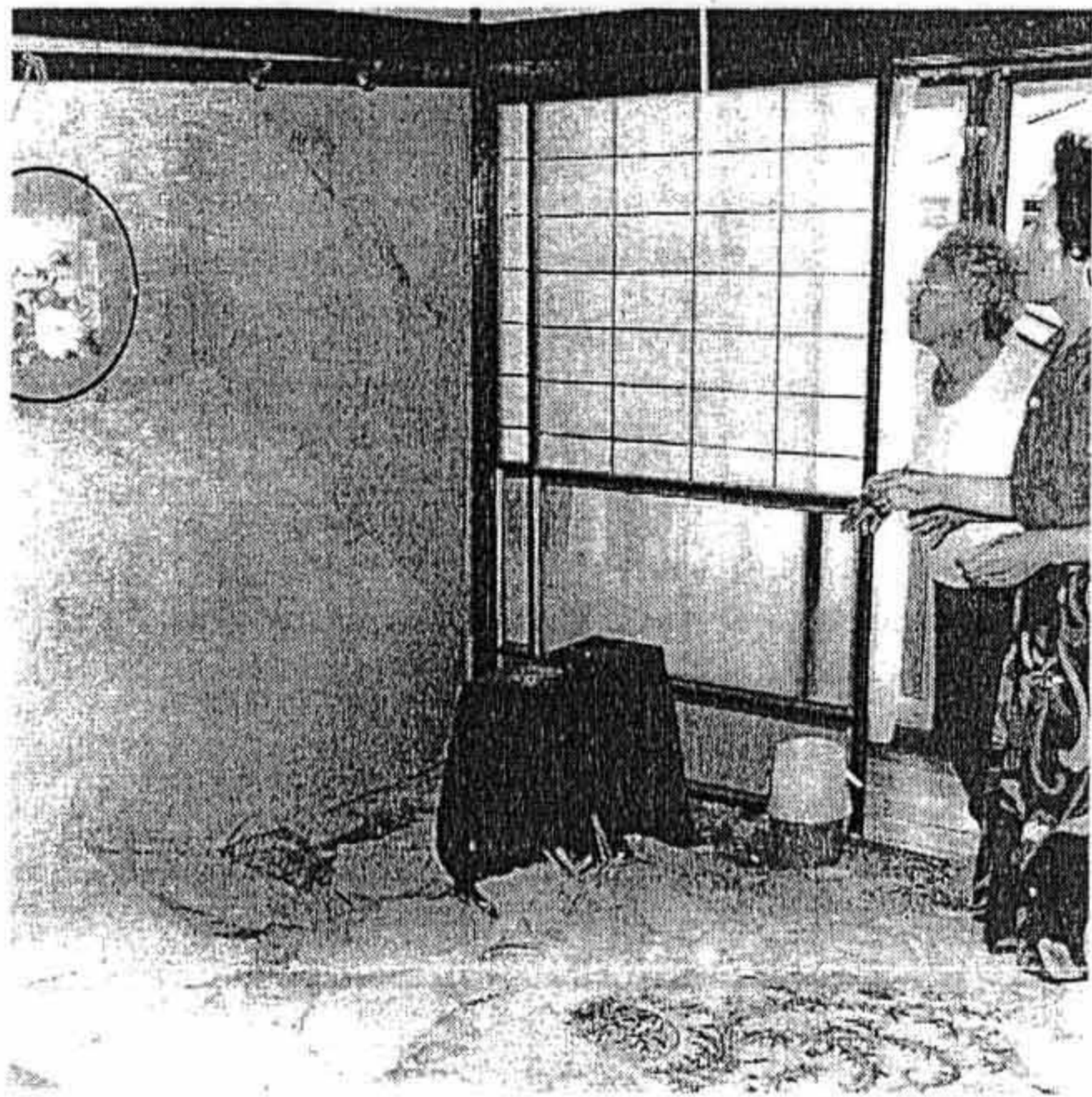
塗り壁が落ちた民家の客間—日南町矢戸
