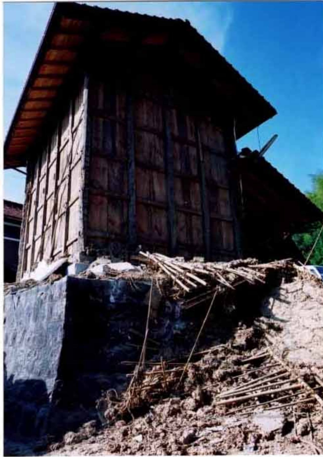
安来市吉佐町 土蔵壁崩落状況
