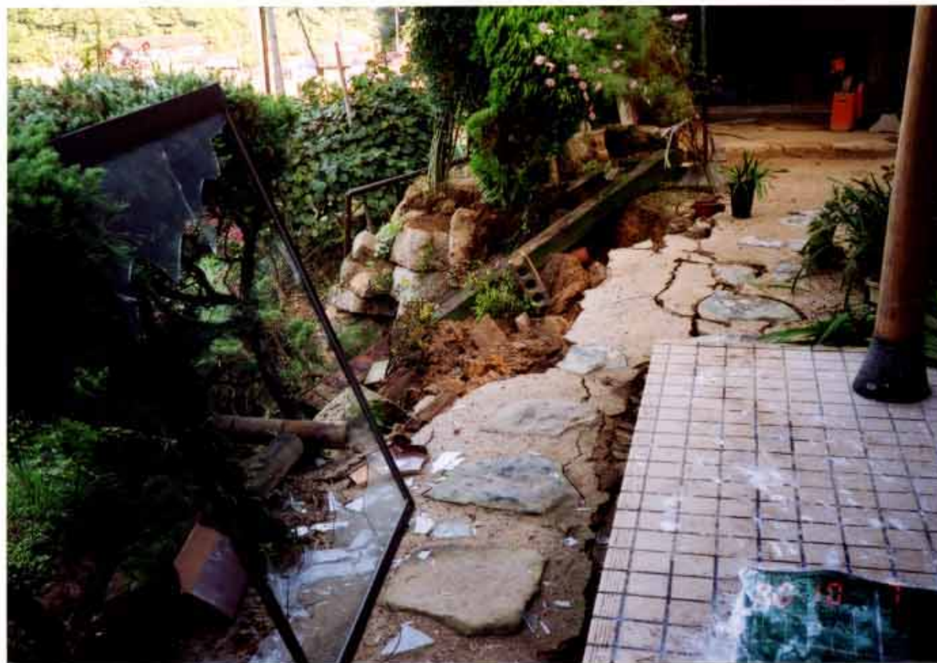
同上 石垣崩落状況
