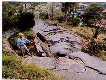
損壊した道路＝日野町
