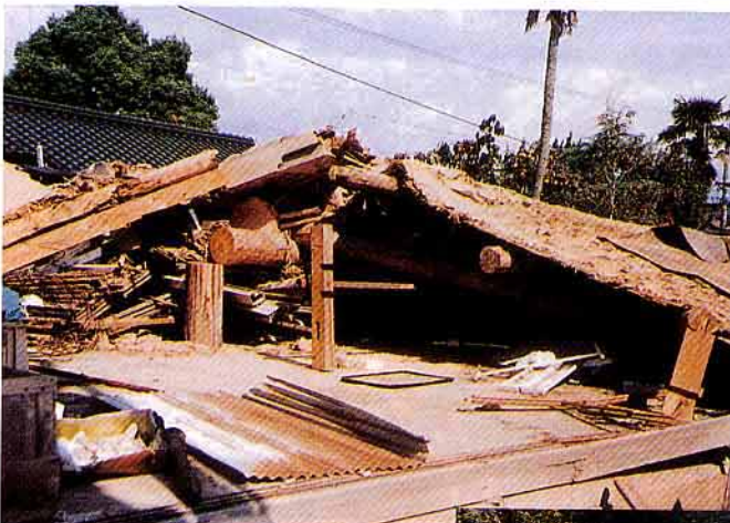
倒壊した民家＝米子市
