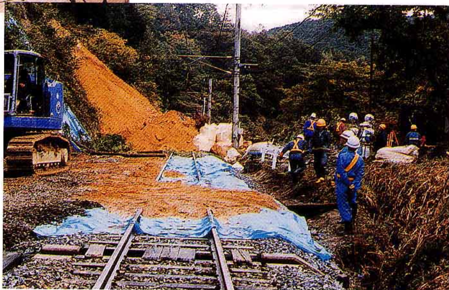
写真2-1 鳥取県西部の建物、鉄道等の被害写真 (提供 鳥取県住宅供給公社)
