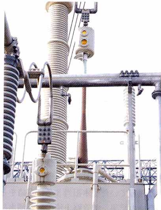
写真2 赤相2次側ブッシング破損
