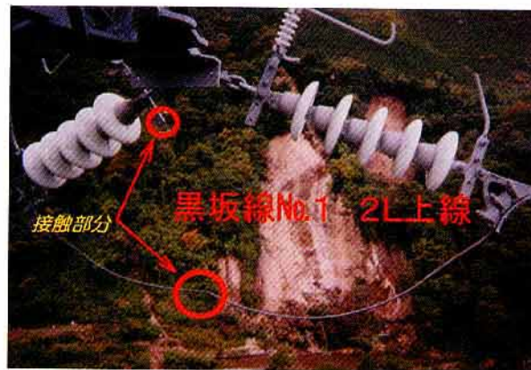
写真4 66kV黒坂線 ジャンパー接触 (写真はNo.1鉄塔1号上線)
