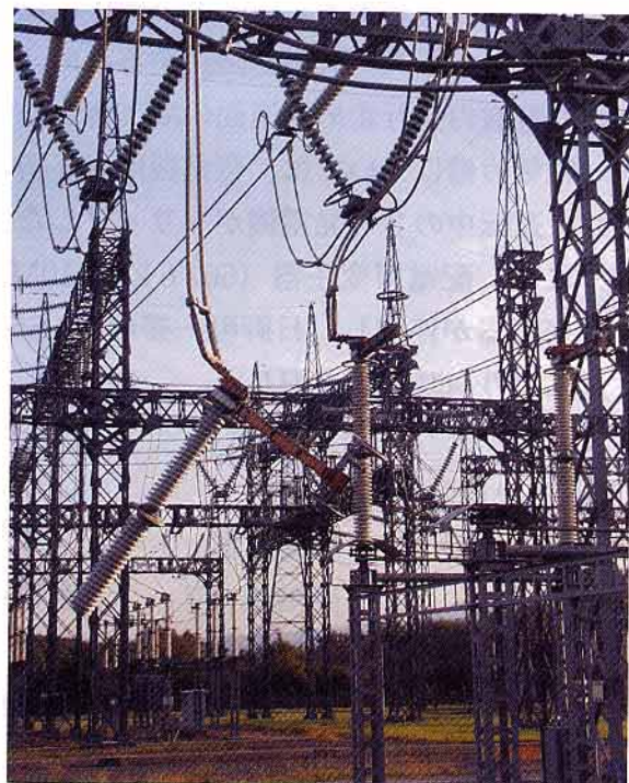
写真4 北松江幹線1L断路器がいし折損
