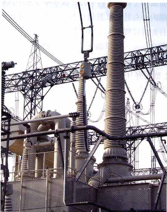
写真3 青相2次側ブッシング破損
