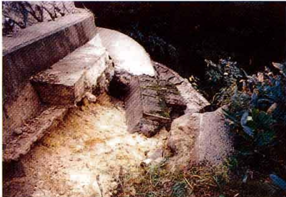
写真5 66kV黒坂線擁壁損壊状況 (No.50鉄塔)
