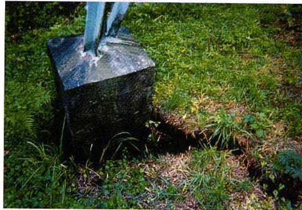
写真2 66kV鉄塔敷地の地割れおよび基礎周辺の間隙状況
