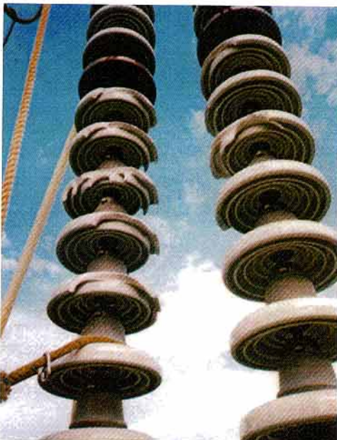
写真3 220kV北松江幹線碍子破損 (No.82鉄塔1号上線, 2連懸垂装置)
