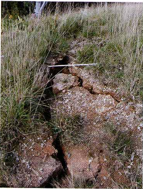
写真1 500kV鉄塔敷地の地割れ状況
