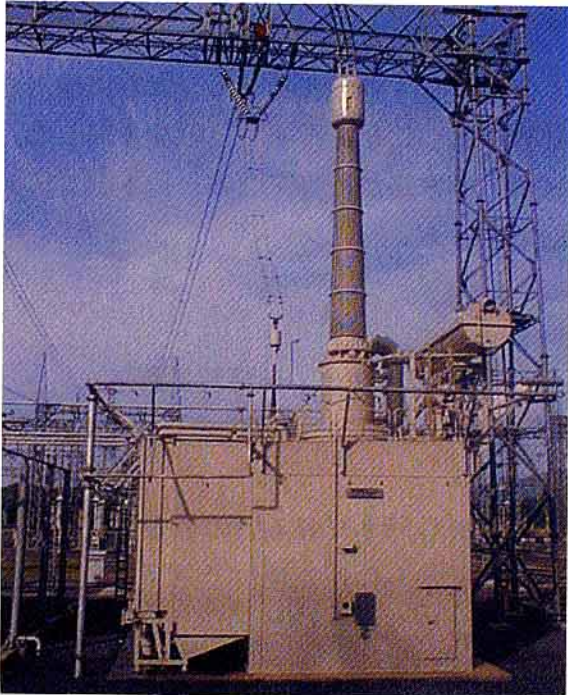
写真1 赤相Tr全景(2次ブッシング破損)
