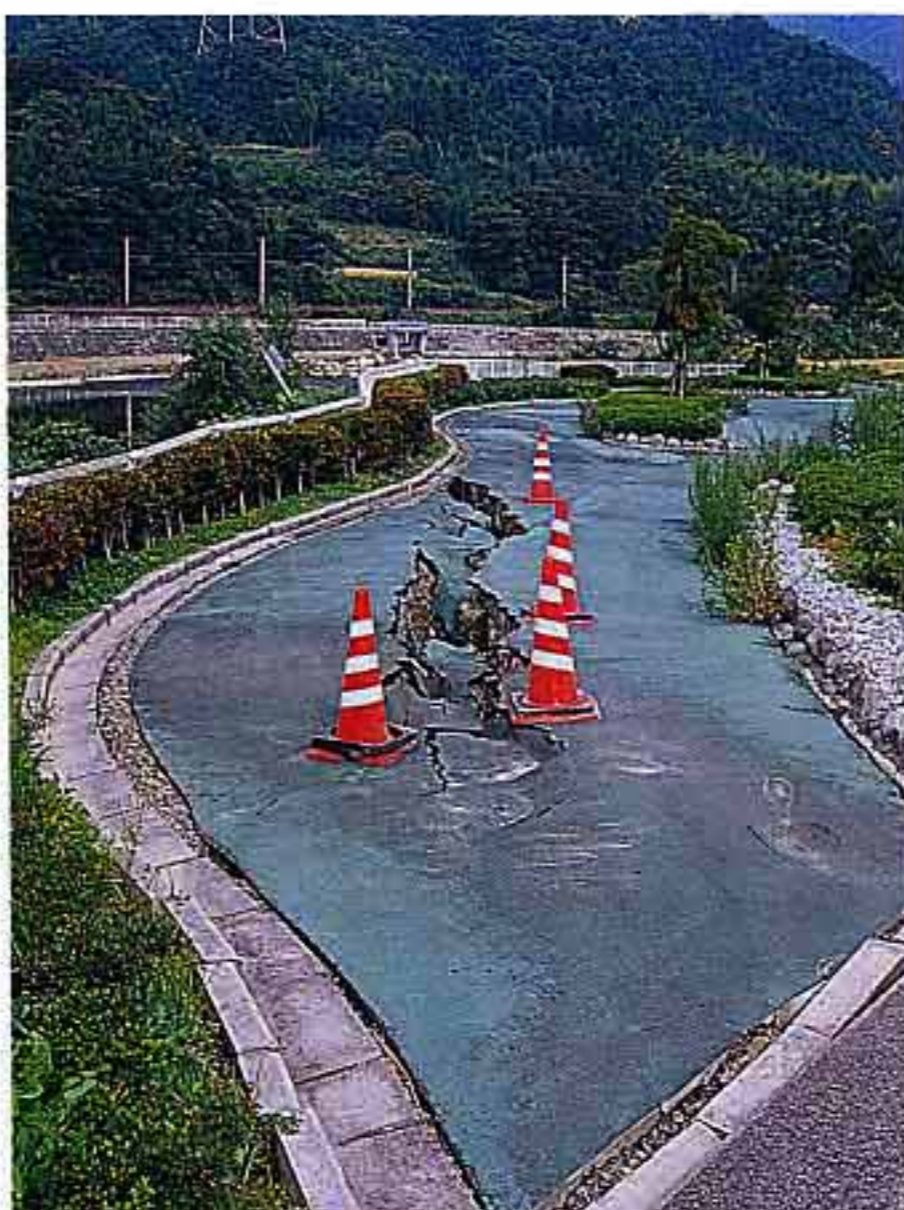
歩道に発生した地割れ
