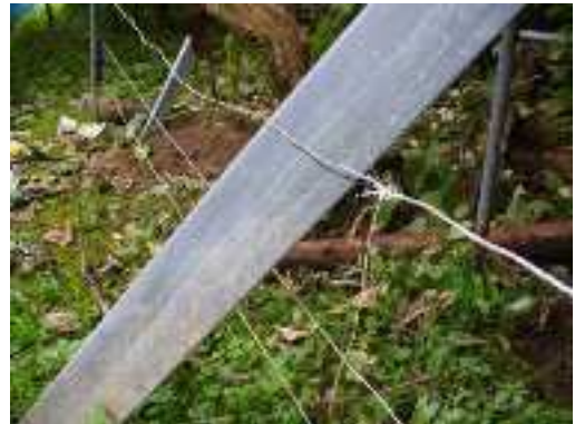
▲果樹園の柵の支柱に電線が触れて、漏電している。
