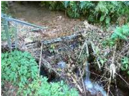
▲増水により破損した金網柵 河川・水路は、獣類の通り道・エサ場になる。 柵で封鎖するのは困難である。
