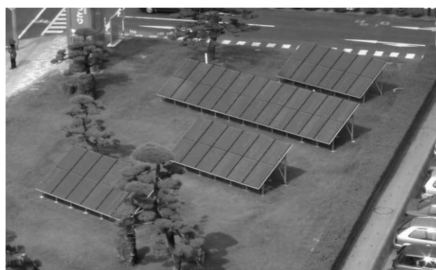
太陽光発電システム 10kW
