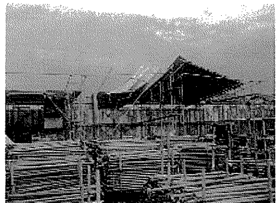
めくれあがった資材置き場の屋根
