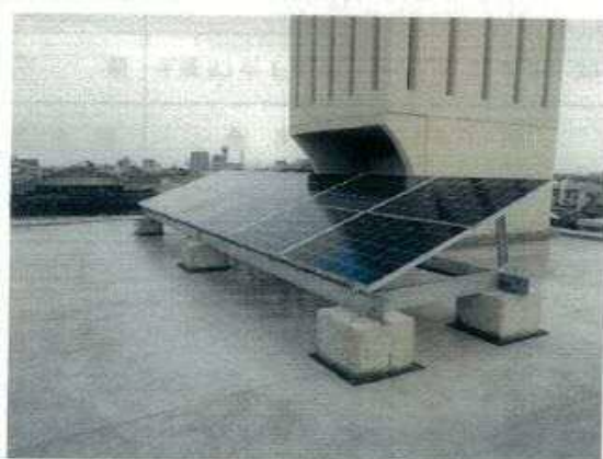
県営住宅の屋上に設置した太陽光パネル
