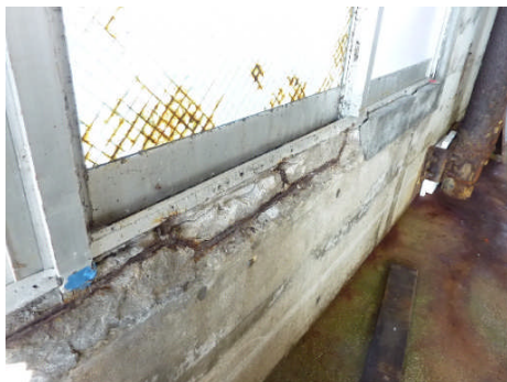
ブロック壁面の破損（2号上屋）
