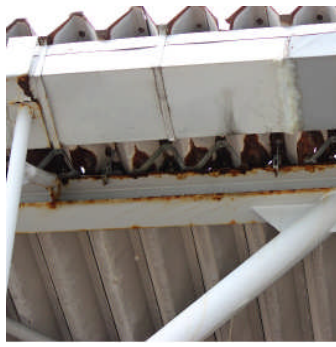
腐食が進む屋根（3号上屋）
