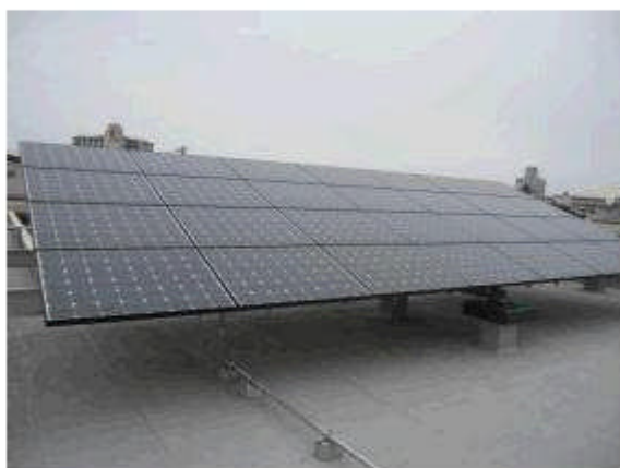
▲太陽光発電システム
