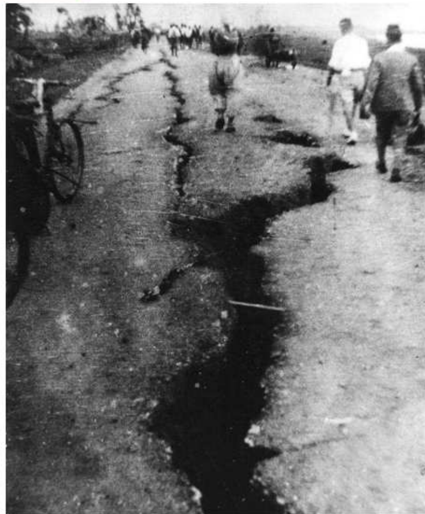
道路の地割れ
